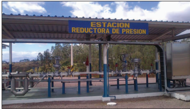
FIGURA 1-6: ESTACIÓN REDUCTORA DE PRESIÓN
