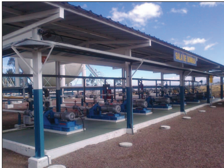
FIGURA 1-12: UNIDAD DE BOMBEO
