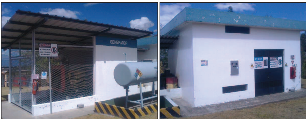
FIGURA 1-19: ÁREA DE TRANSFORMADORES Y GENERADOR
