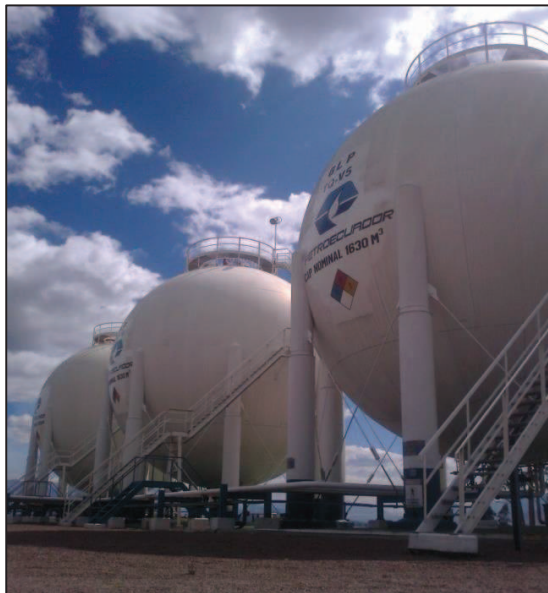
FIGURA 1-8: ESFERAS PRESURIZADAS DE ALMACENAMIENTO DE GLP
