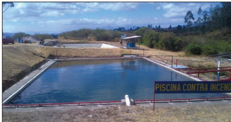
FIGURA 1-16: PISCINA CONTRA INCENDIOS
