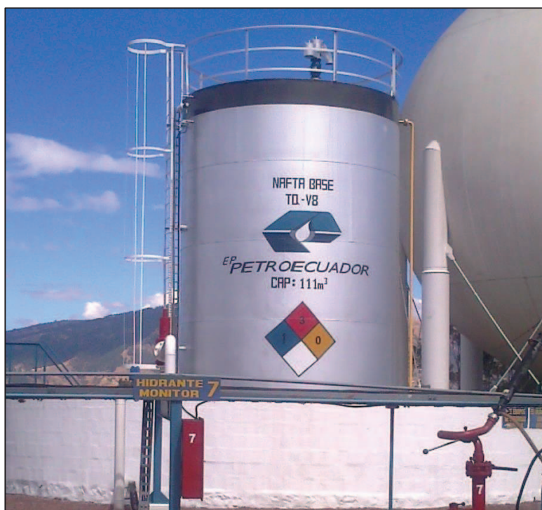
FIGURA 1-10: TANQUE ATMOSFÉRICO SLOP
