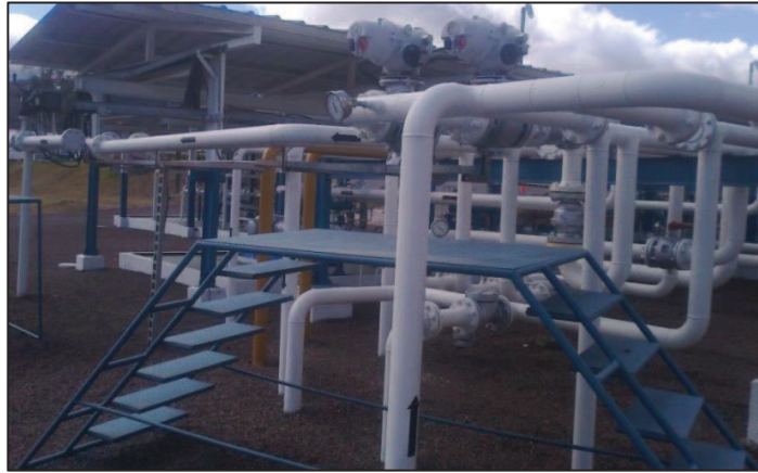
FIGURA 1-7: MANIFOLD DE DISTRIBUCIÓN
