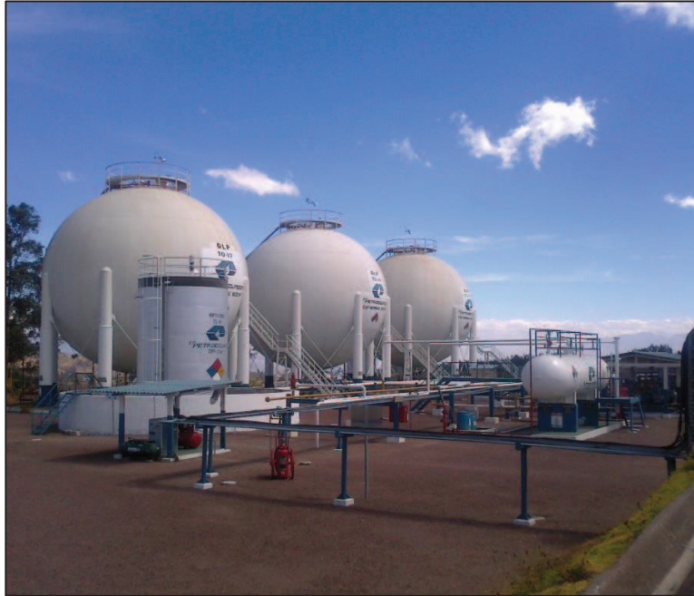
FIGURA 1-1: VISTA LATERAL DEL TERMINAL DE GLP OYAMBARO
