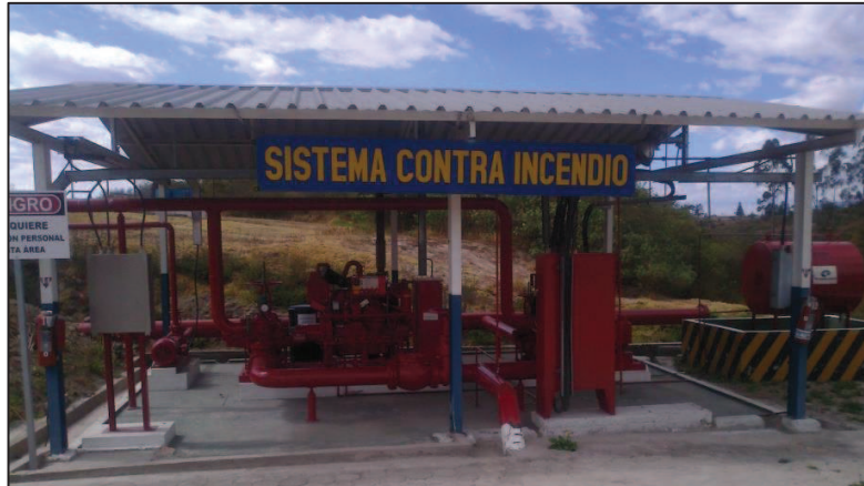
FIGURA 1-15: SISTEMA CONTRA INCENDIOS
