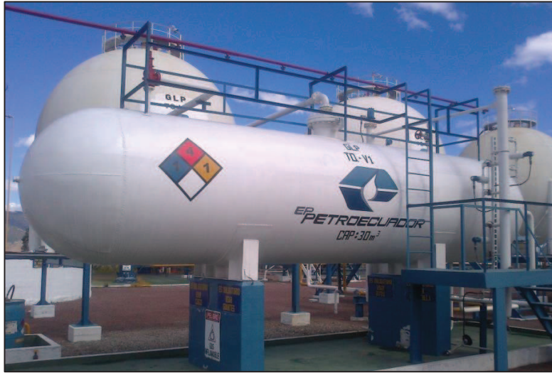
FIGURA 1-9: TANQUE SEPARADOR BULLET
