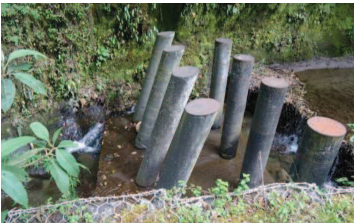
Fotografía 4.34: Dique abierto de columnas verticales con muro de gaviones (vista lateral)
