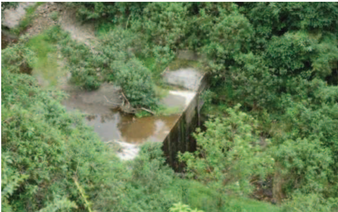
Fotografía 4.44: Dique cerrado con orificios de salida
