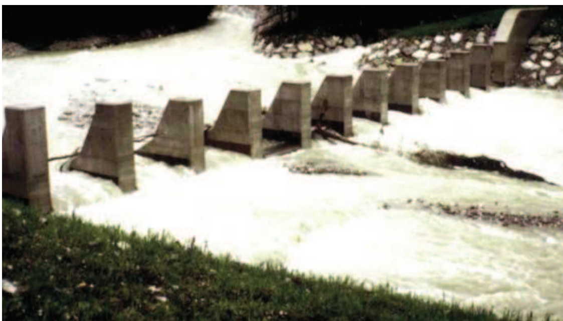
Figura 3.10: Obra de hormigón diseñada para captura de material vegetal
