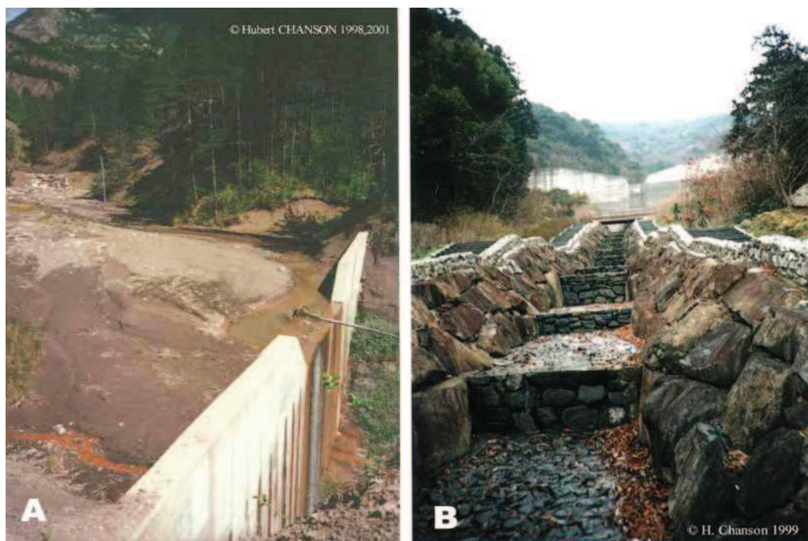
A) Presa llena de sedimentos
