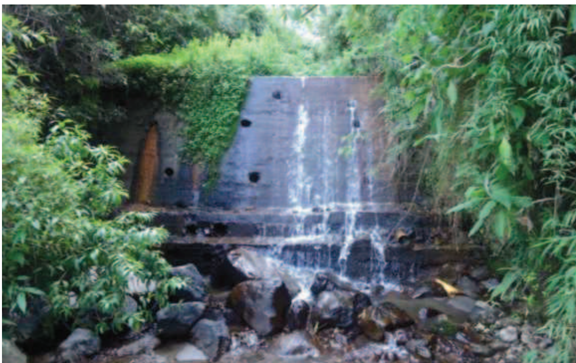
Fotografía 4.47: Dique cerrado con orificios de salida
