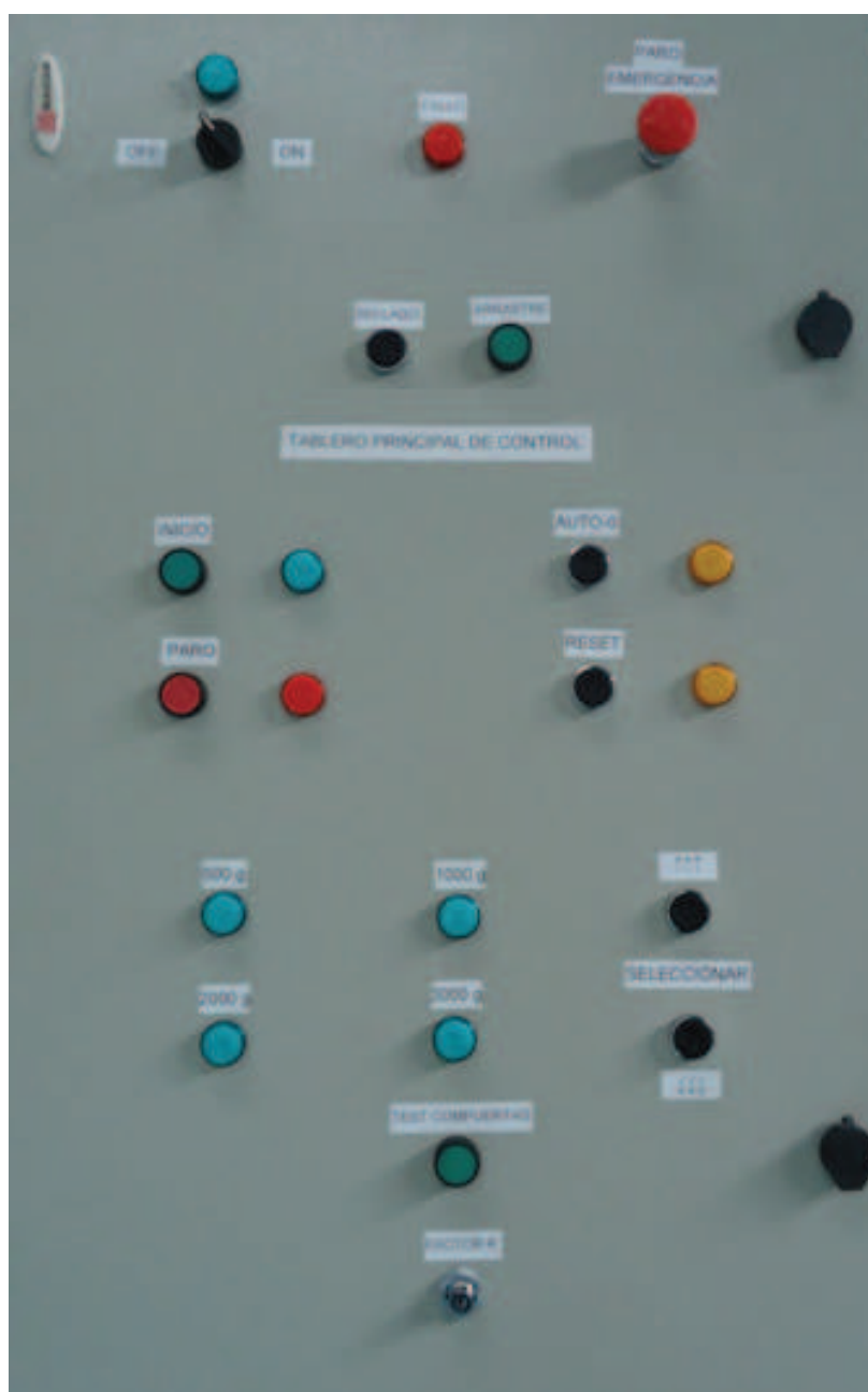
Figura 2.39 Distribución externa del tablero principal de control
