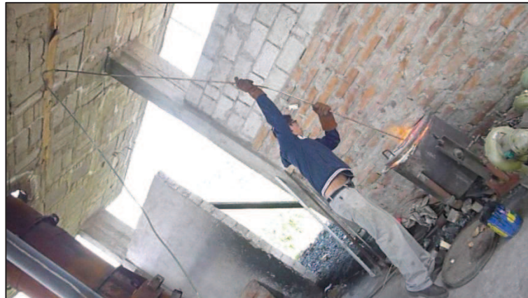
Figura 3. 27. Suministro de oxígeno en el interior del horno.
