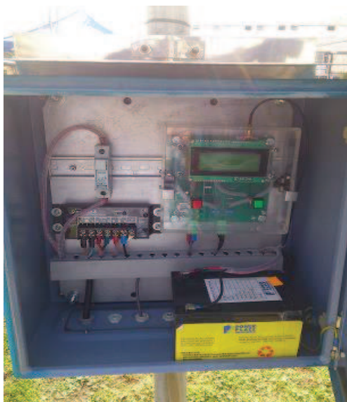
Figura 4.14 Caja de Protección del Módulo de Temperatura y Humedad Relativa como del Módulo de Precipitación
