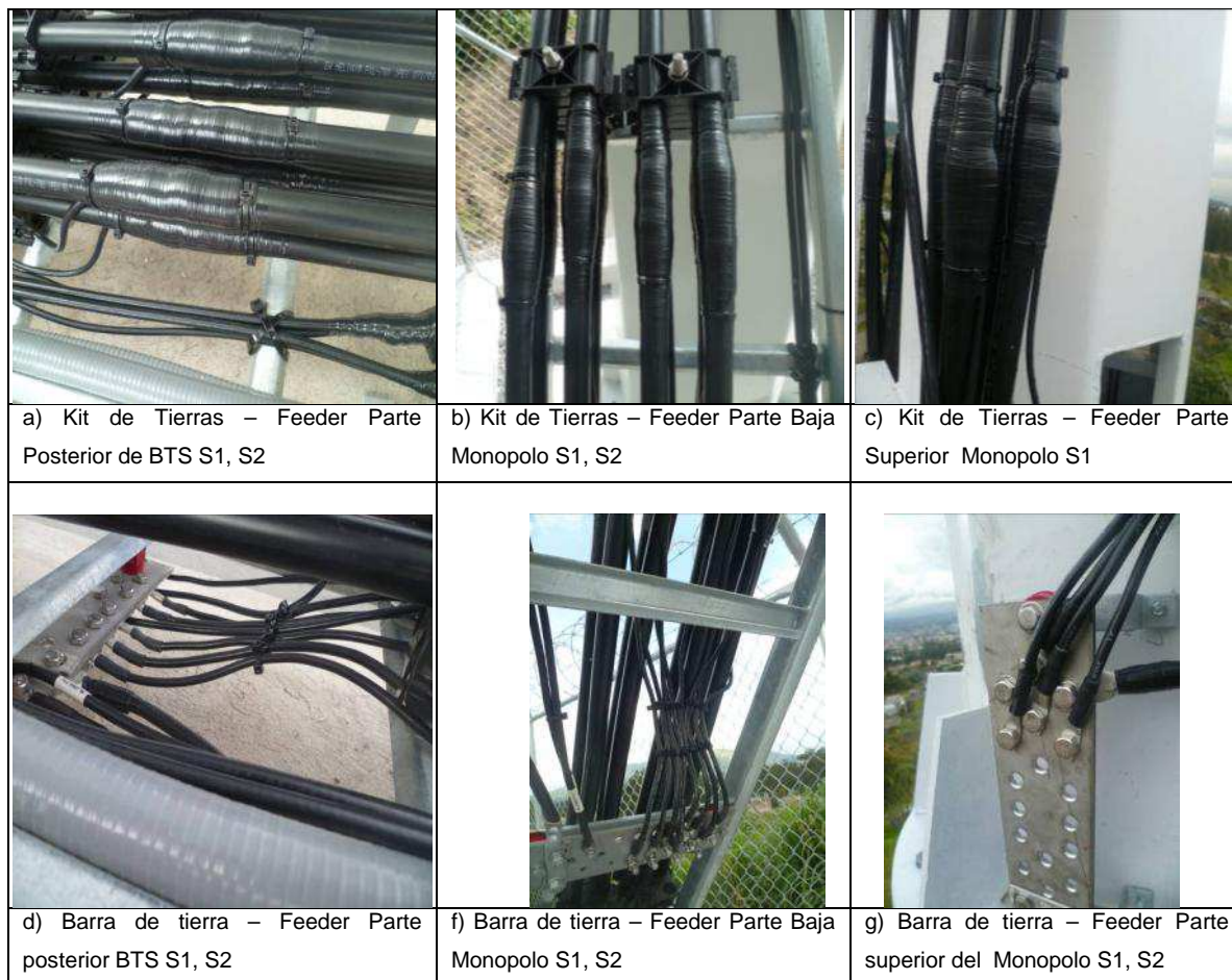
Figura 2.53 Aterramientos y Vulcanizados
