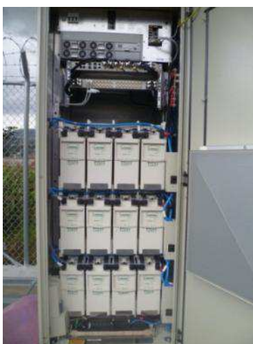
Figura 2.38 Banco de Baterías del Rack de Servicio
