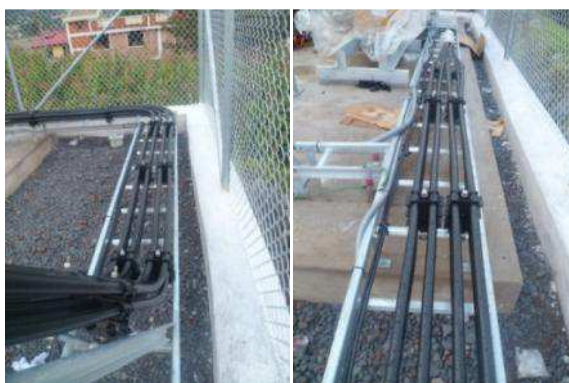
Figura 2.52 Claneado Horizontal de Feeder
