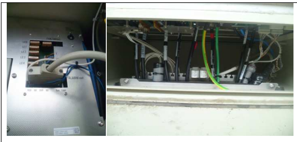
Figura 2.36 Cable propietario que transporte Alarmas en BTS Nokia
