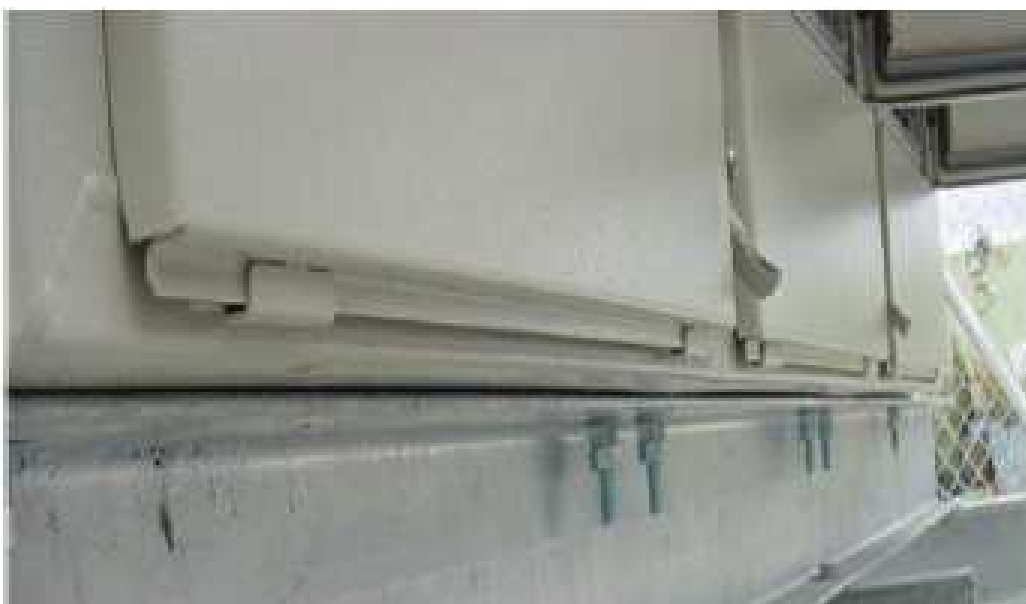
Figura 2.33 Anclaje de Rack NSN
