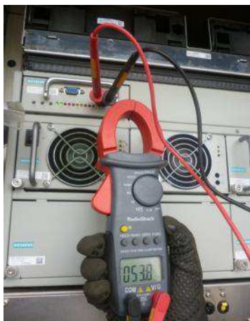
Figura 4.6 Medición de Voltaje de Rectificador que Alimenta el Enlace
