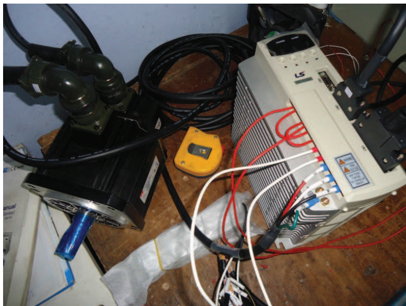
Figura 4.1 Verificación de conexiones del sistema Servo-Drive.
