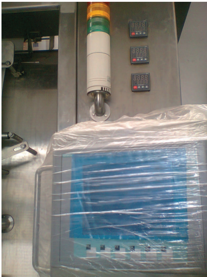
Figura 2.27 Vista exterior del tablero de control
