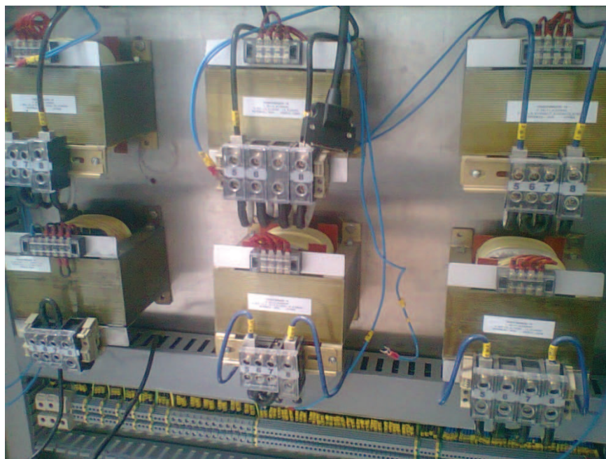
Figura 1. 12 Transformadores para el sellado y corte.
