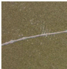
Figura 1.12 Placa con defecto de agrietamiento (CISP, 2010b, p. 5)
