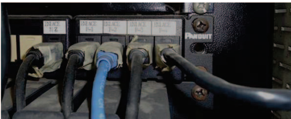
Figura 2-14 Etiquetado deficiente en el cableado vertical
