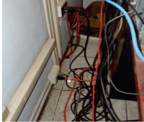
Figura 2-15 Deficiencia en la administración del cableado
