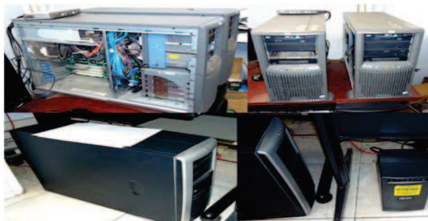
Figura 2-17 Cuarto de equipos
