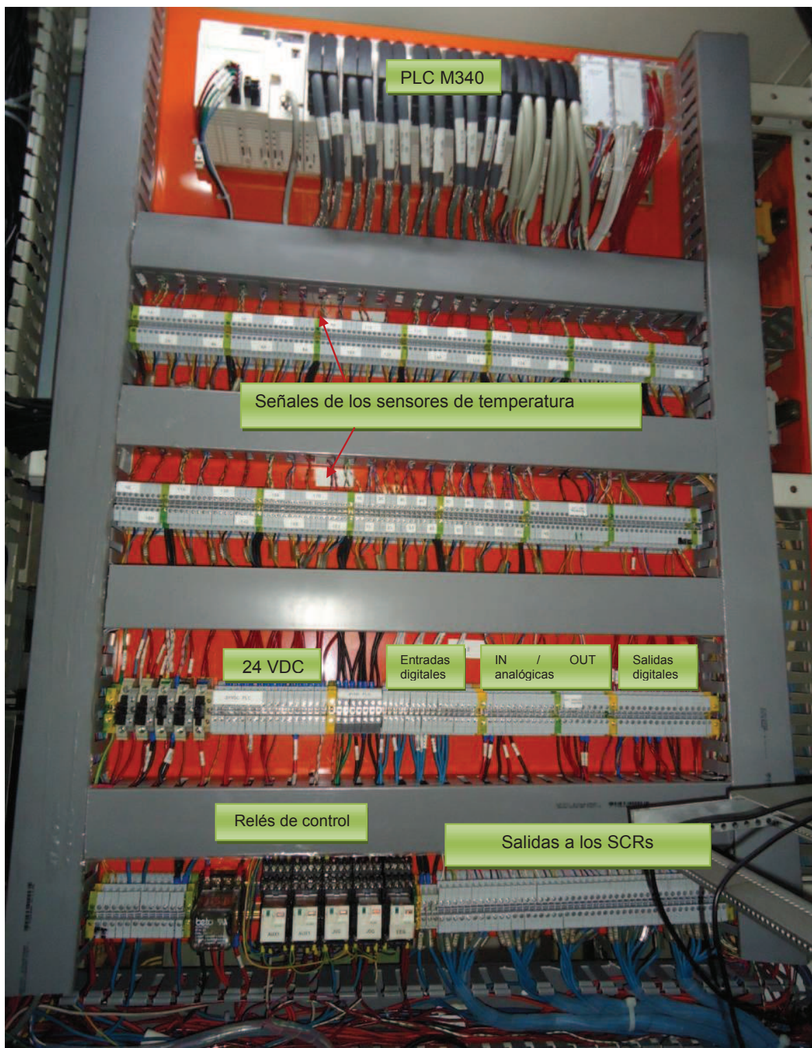
Figura 2. 9 Fotografía del nuevo tablero de control de la máquina texturizadora B3
