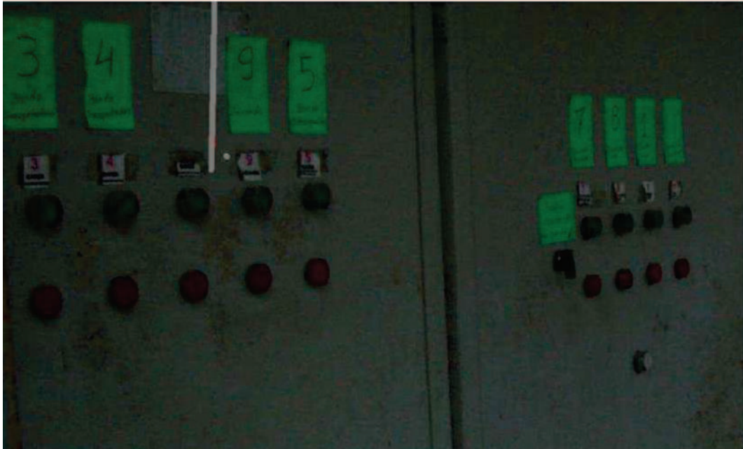
Figura 3. 32: Tableros de control de la trituradora de piedra marca MINYU.
