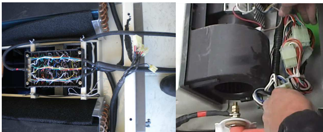
Fig. 55.- Conexiones y amarre de cables Archivo fotográfico personal
