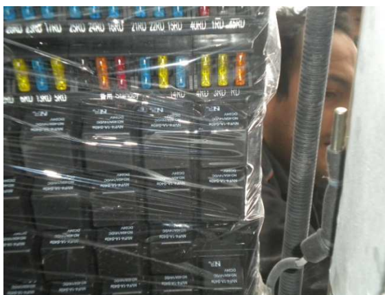
Fig. 60.- Central eléctrica, relés y fusibles (parte frontal) Archivo fotográfico personal
