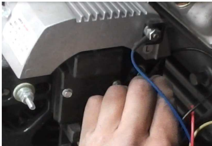
Fig. 49.- Conexión eléctrica en alternador Archivo fotográfico personal
