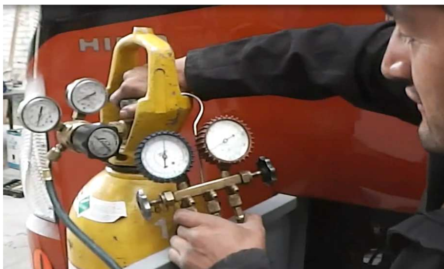
Fig. 68.- Cerrado de llave principal del tanque de nitrógeno Archivo fotográfico personal
