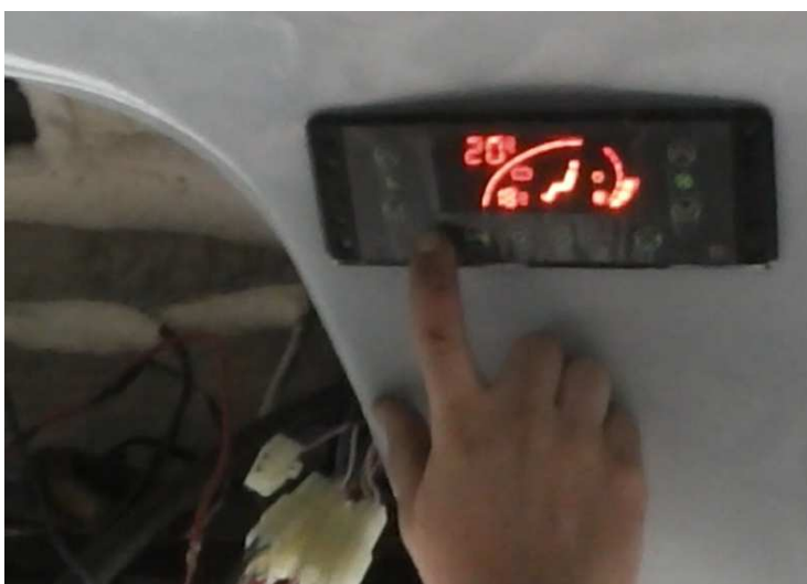
Fig. 58.- Prueba de panel de control Archivo fotográfico personal
