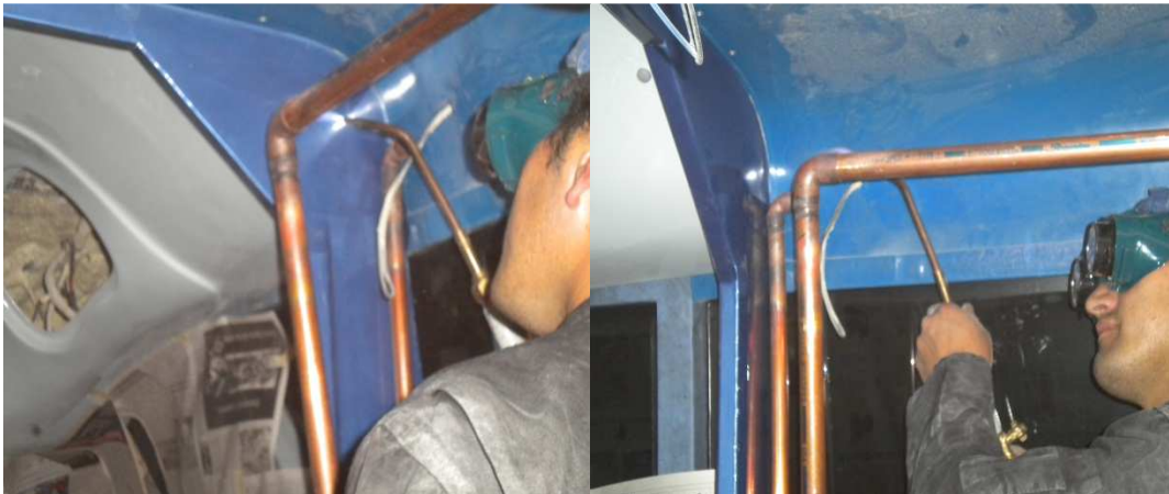
Fig. 34.- Soldaduras sobre cabeza Archivo fotográfico personal
