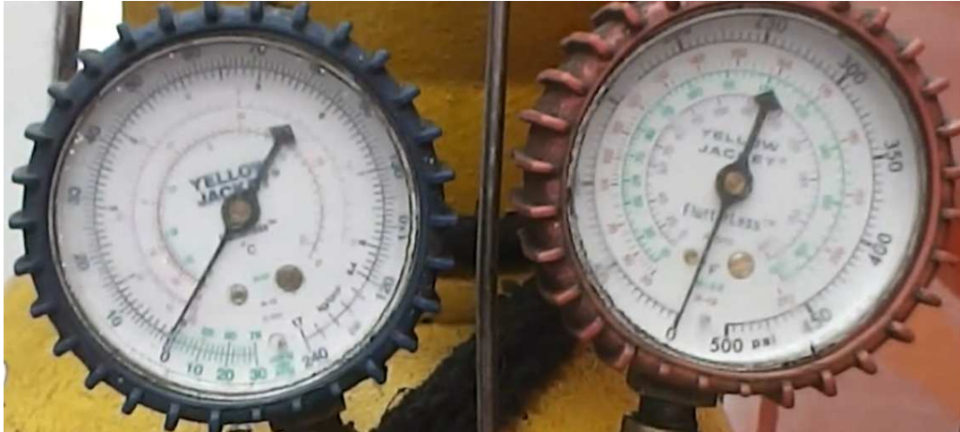
Fig. 69.- Evacuación de nitrógeno del sistema Archivo fotográfico personal
