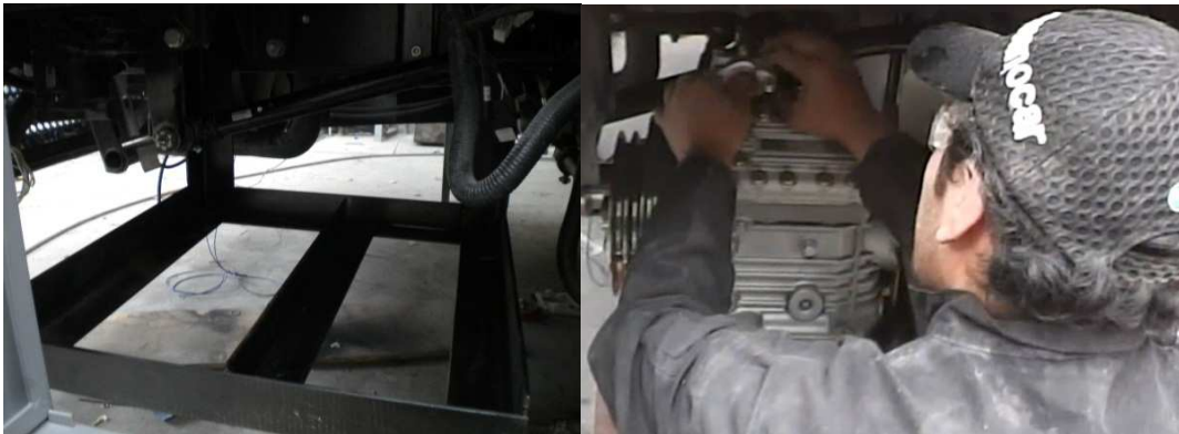
Fig. 14.- Instalación base y compresor Archivo fotográfico personal
