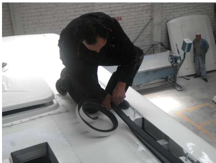
Fig. 18.- Preparación del perímetro de los orificios para montaje de evaporador Archivo fotográfico personal
