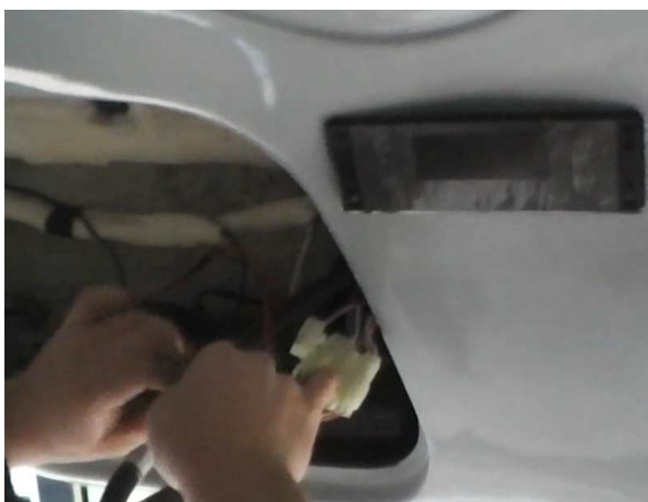
Fig. 57.- Conexión cable de panel de control Archivo fotográfico personal
