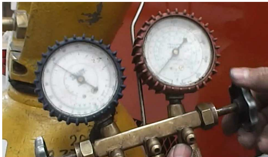
Fig. 67.- Apertura de llaves en manómetro para presurizar el sistema Archivo fotográfico personal
