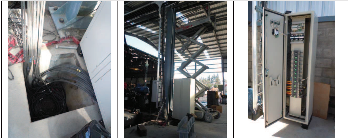
Fig.6.6 Llegada de Cables para acometida de subtablero
