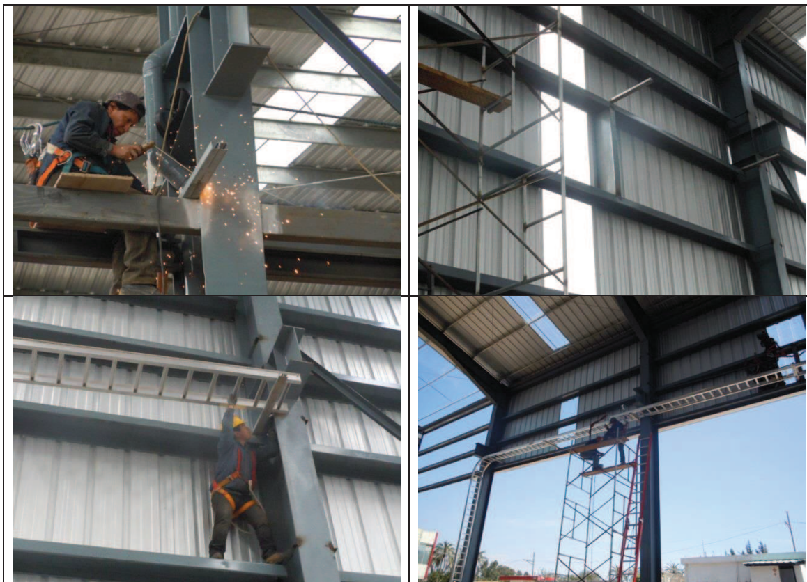
Fig.6.3 Proceso para instalación de Canaletas metálicas para distribución de Acometidas a los diferentes Subtableros de Energía.
