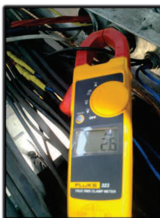
Fig.6.10 Carga en circuito de luminarias Tipo LED.
