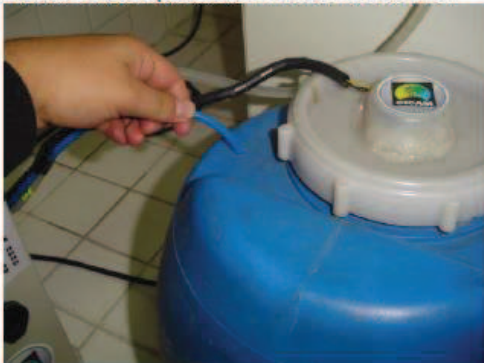
Tanque de agua ultra pura
