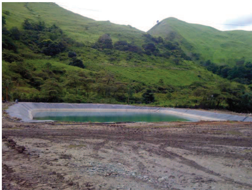
Figura 1.22 Piscina de decantación de relaves
