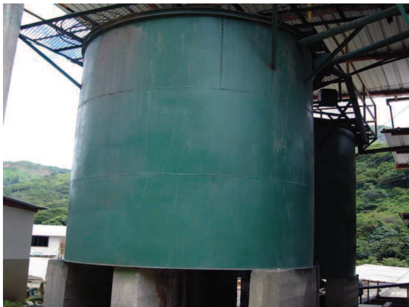
Figura 1.23 Tanque de cianuración
