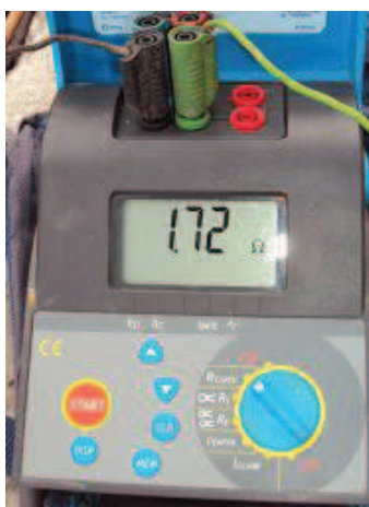
Figura 64 Medición Final del Sistema de Puesta a Tierra
