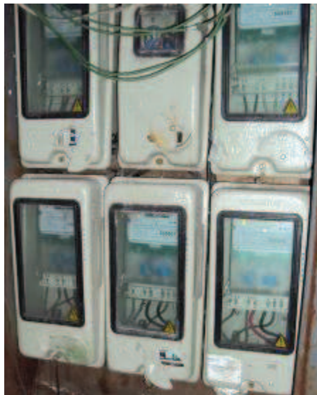
Figura 38 Breaker principales de las acometidas 60A
