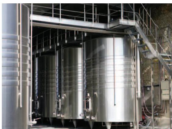
Figura 1.2 Tanques de almacenamiento de acero inoxidable 2 .
