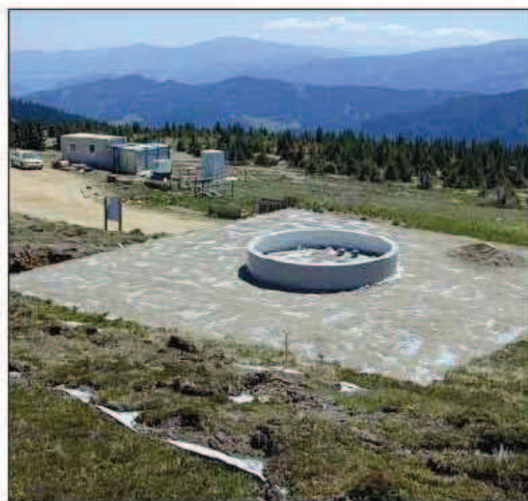
Gráfico 4-14: Base de cimentación de un aerogenerador.
