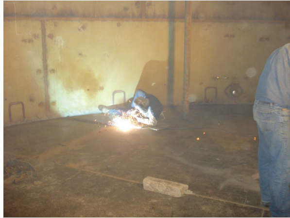
Figura 5. 5. Soldadura de las placas del fondo del tanque Fuente: PEC Cía. Ltda., 2013
