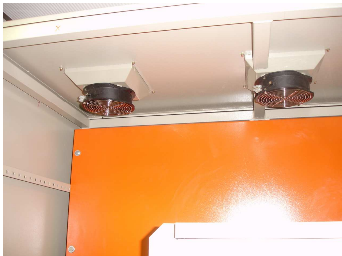
Figura 5. 4 Extractores en la parte superior del armario
