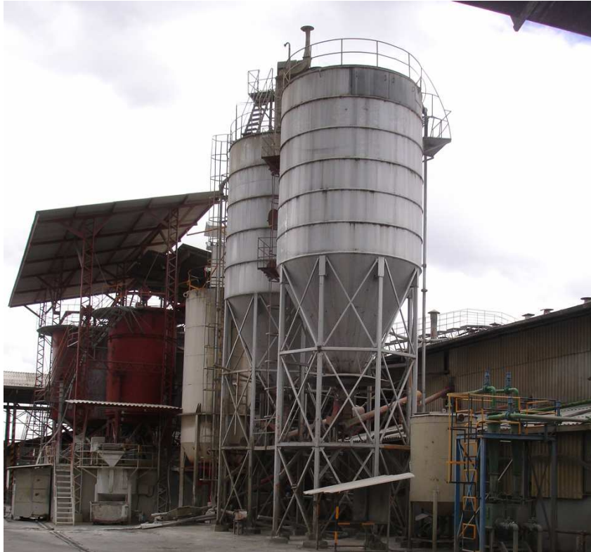
Figura 1. 5 Silos de cemento
