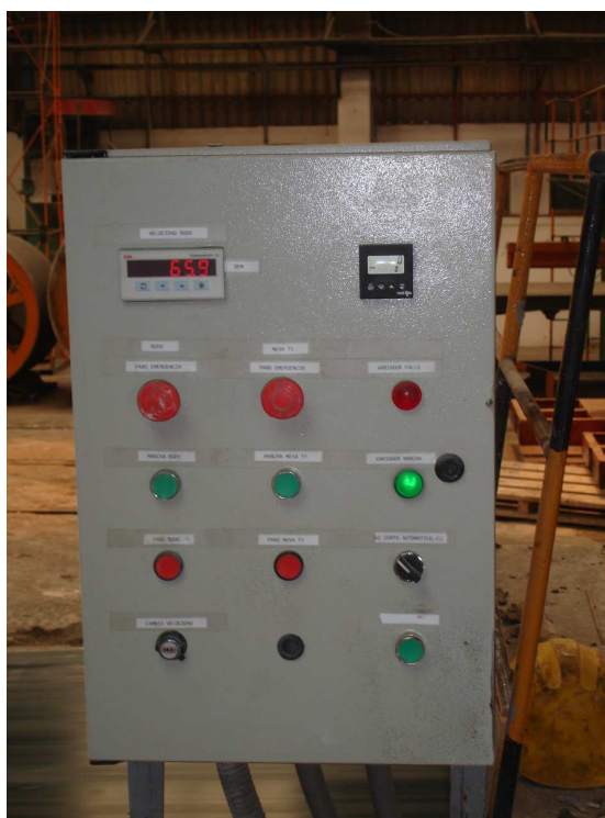
Figura 5. 13 Tablero de control de operación del sistema de rodillos
