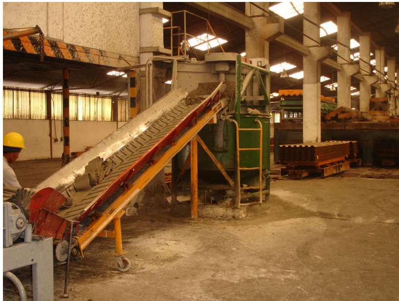
Figura 1. 12 Tanque de material sobrante de las planchas
