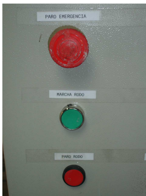
Figura 3. 3 Pulsantes de marcha/paro/emergencia
