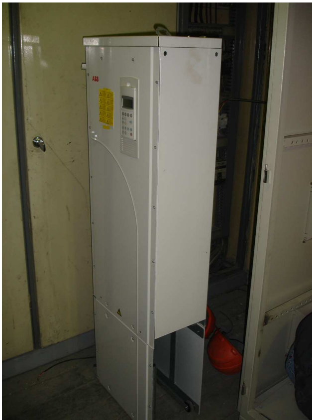
Figura 5. 9 Armario del variador de velocidad sin pedestal
