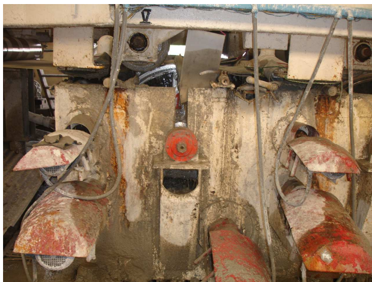
Figura 1. 7 Motores de agitadores de los tanques separadores
