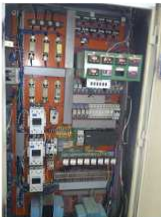
Figura 1.20 Tablero de control de movimiento hidráulico y controladores de temperatura 2 .
