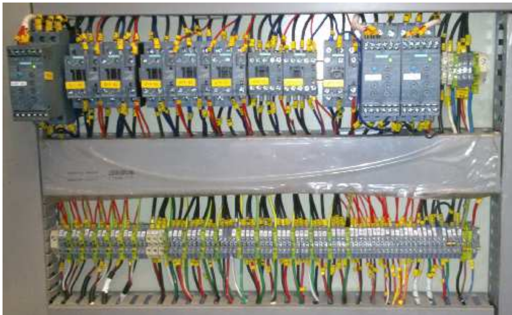
Figura 4.6 Contactores, arrancadores y borneras de potencia. 21
