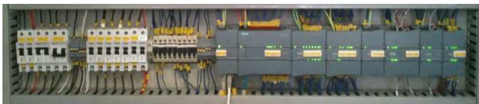
Figura 4.2 Protecciones, PLC y módulos. 21
