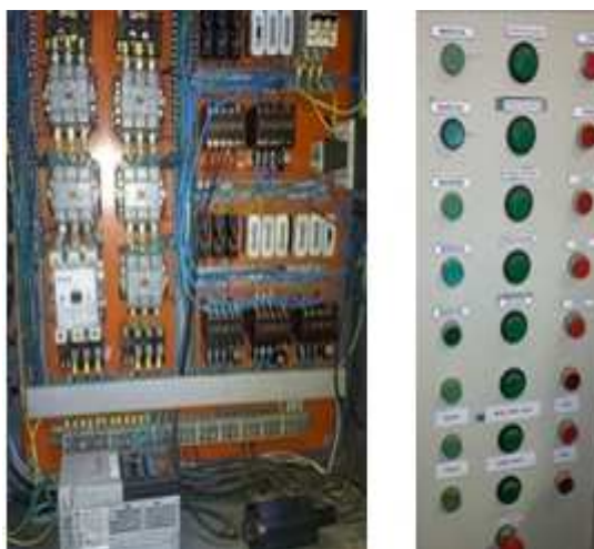
Figura 1.19 Tablero de auxiliares encendido de bombas y extractores 2 .
