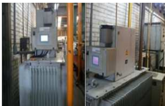
Figura 1.13 Rectificadores de corriente continua 2 .
