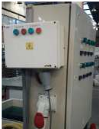
Figura 1.21 Tablero control de bombas y temperaturas en galvanoplastia 2 .
