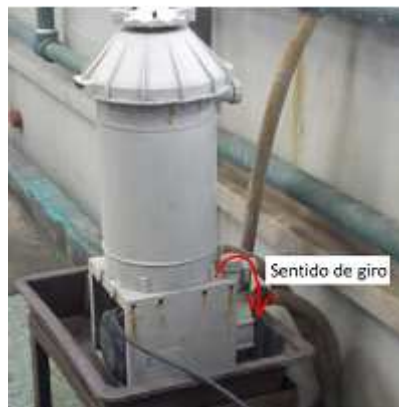
Figura 4.15 Bomba de filtrado y recirculación. 2
