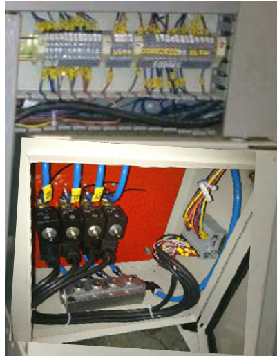
Figura 4.7 Borneras de voltaje DC y caja de válvulas neumáticas. 21
