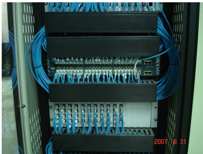
Figura 2.7 Equipos de interconectividad en el Edificio Villafuerte - Mezzanine
