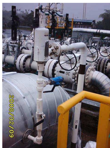
Grafico 3. Foto del sistema de válvulas de seguridad
