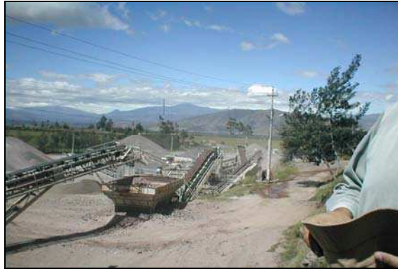
Fotografía No. 1, Planta de Agregados Rocafuerte en Pifo, pilas de material y máquinas de trituración.
