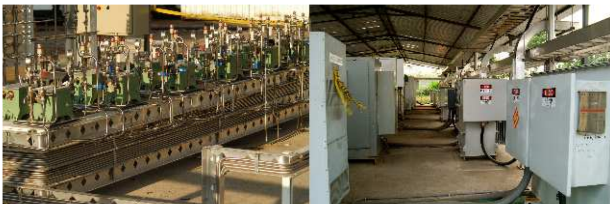
Gráfico N° 1.3.4: Banco de bombas Químicas, transformadores y variadores.
