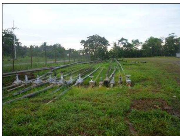
Gráfico N° 1.2.3: Varias tuberías provenientes de pozos 1
