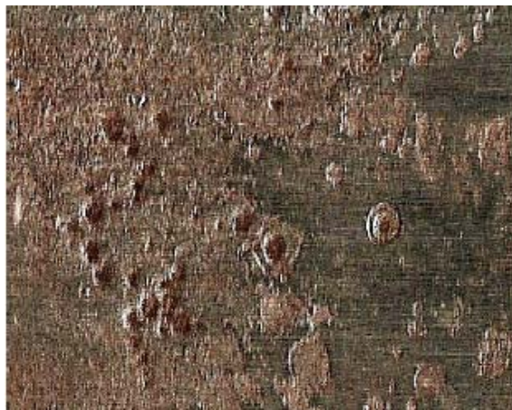
Figura 2.5- Corrosión por picadura debido a la presencia de CO 2
