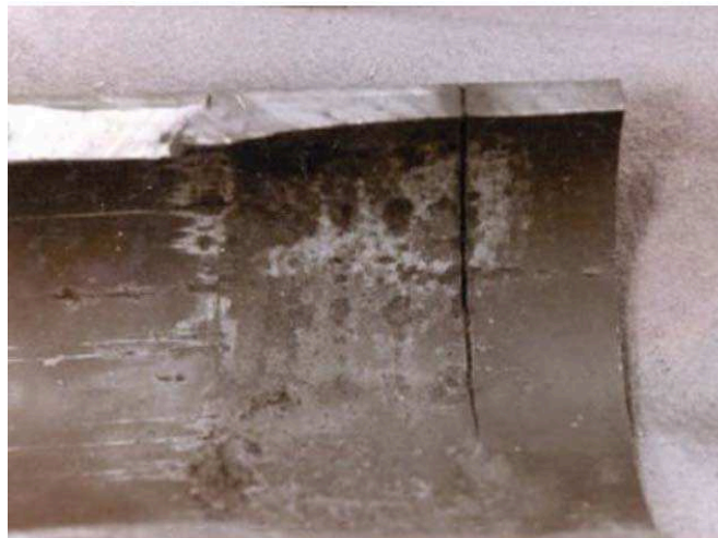
Figura 2.4- Corrosión bajo tensión en tubería
