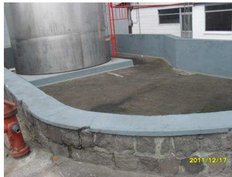
Fig. 4.7.- Dique de contención para alcohol
