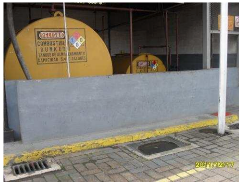
Fig. 4.6.- Dique de contención para combustible
