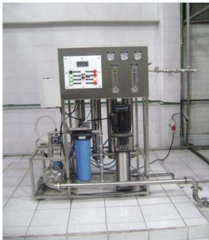
Fig. 3.12.- Equipo de Osmosis Inversa.
