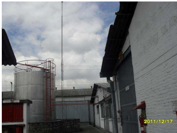
Fig. 4.8.- Sistema de enfriamiento tanque (tubería roja) y pararrayo.
