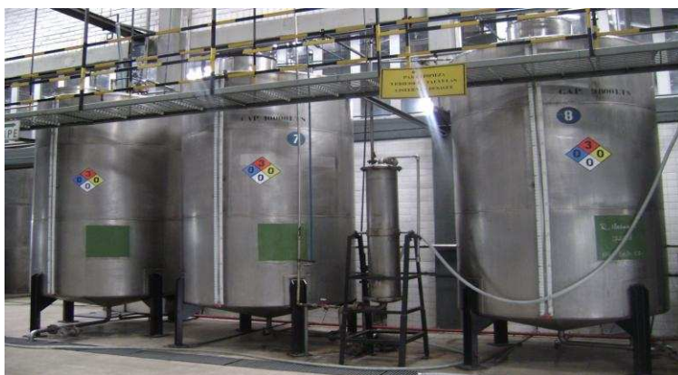
Fig. 3.17.- Tanques de Acero Inoxidable
