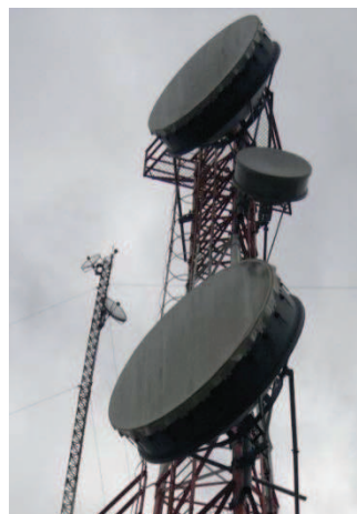
Figura 2.4: Cobertores para antenas de telecomunicación 71
