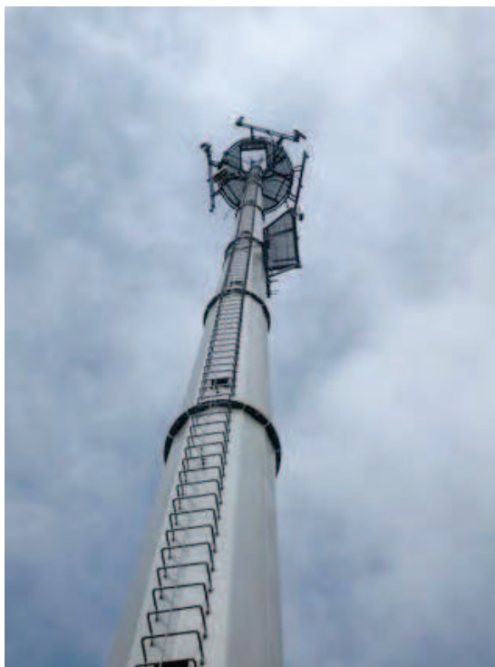
Figura 1.2: Torre tipo monopolo 2
