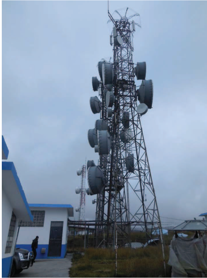
Figura 1.3: Torre de telecomunicación autoportada 3
