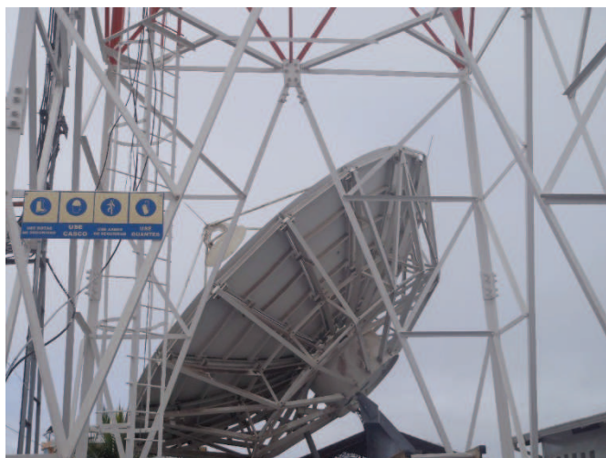
Figura 2.1: Antena de telecomunicación 68
