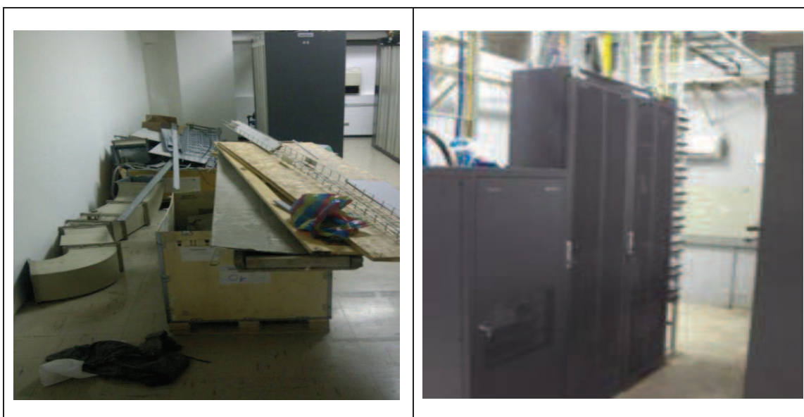
Figura 48 – SEISO, ambiente de trabajo en cuarto de equipos de CNT EP (Marcelo González y Héctor Erazo)
