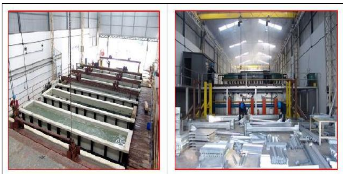
Figura 2.6 – Vista interior de la planta de galvanizado en caliente. (Sedemi S.C.C., 2012)
