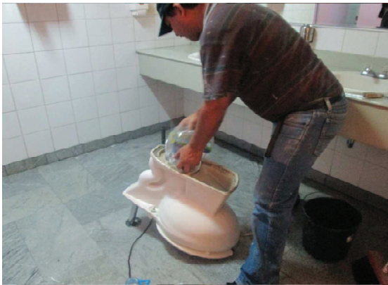
Figura 3.7- Foto descriptiva mantenimiento de inodores Fuente: (Edificio MTOP, 2013)
