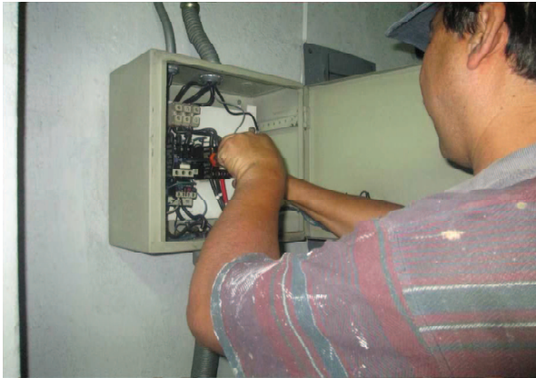
Figura 3.6- Foto descriptiva conexión eléctrica Fuente: (Edificio MTOP, 2013)
