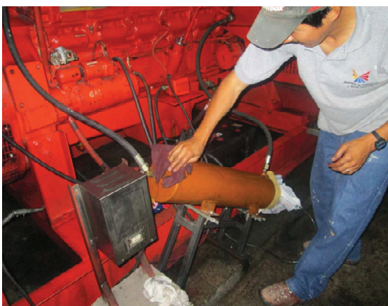
Figura 3.2- Foto descriptiva engrasado de motogenerador Fuente: (Edificio MTOP, 2013)
