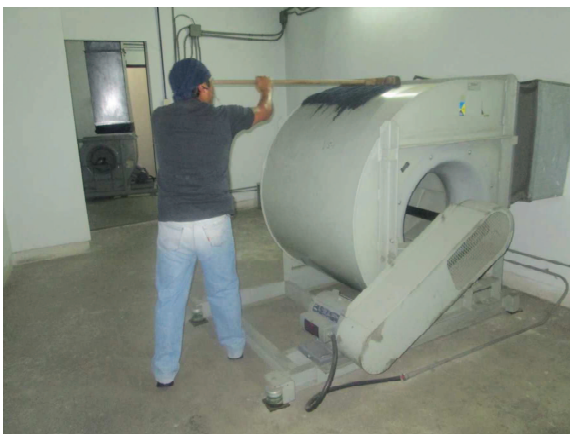
Figura 3.8- Foto descriptiva limpieza de ventiladores Fuente: (Edificio MTOP, 2013)
