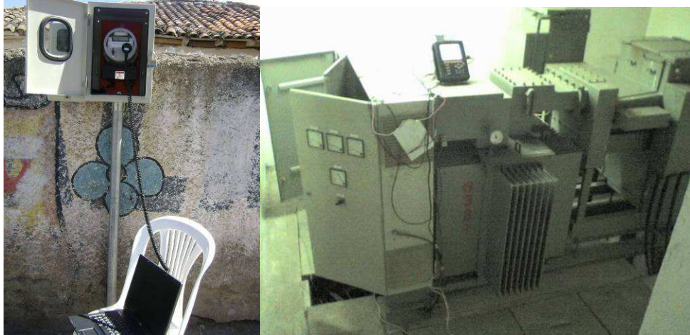
Gráfico 3.10 Obtención de registros de demanda en transformadores
