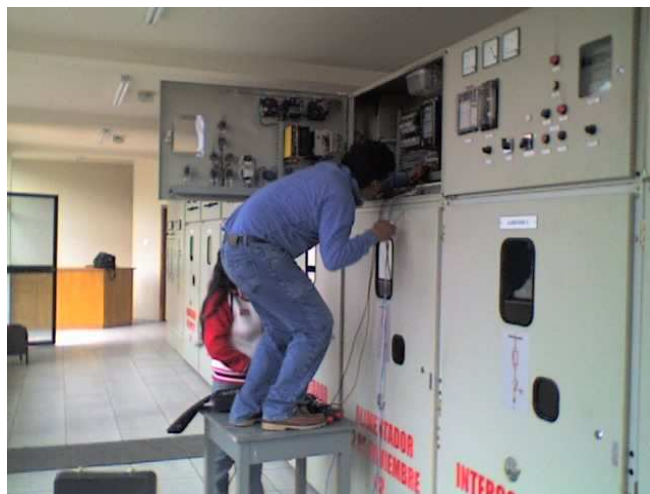
Gráfico 3.3 Instalación del analizador de energía en la cabecera del alimentador
