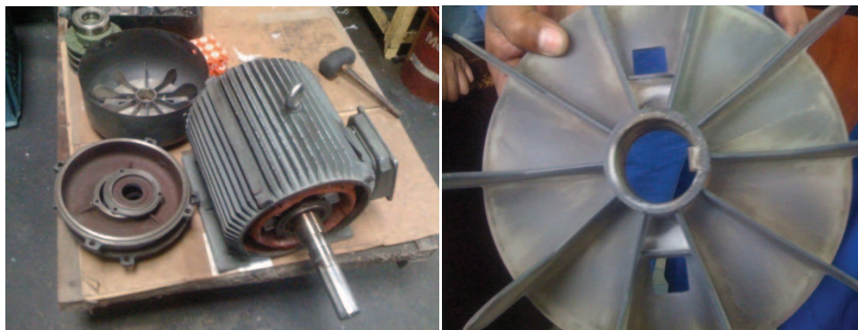
Figura AVI.4. Fotografías antes y después del mantenimiento del motor del ventilador
