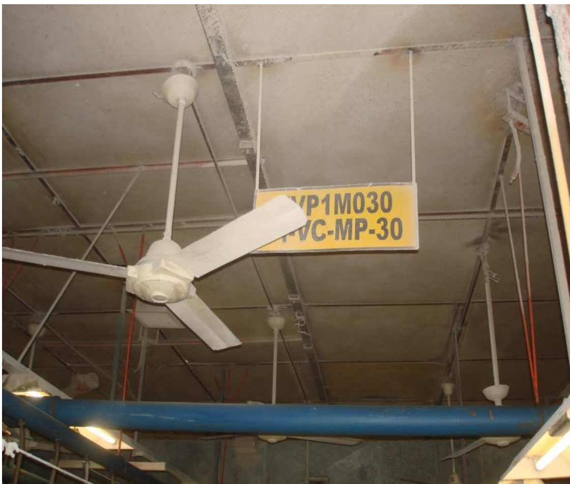
Figura 3.3. Fotografía que muestra los ventiladores instalados en el área de vaciado (EDESA, 2011)
