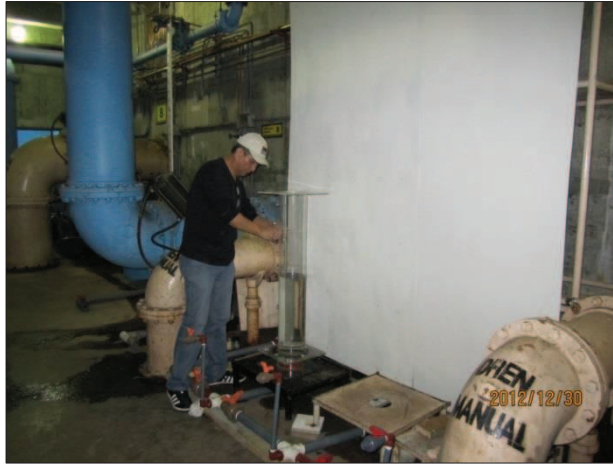
Fuente: Filtro piloto, PTAP
