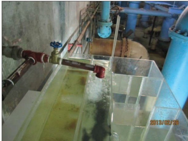
Fuente: Filtro piloto, PTAP
