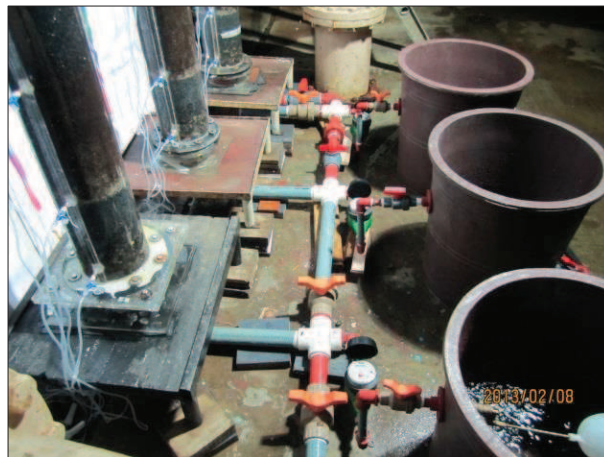
Fuente: Filtro piloto, PTAP
