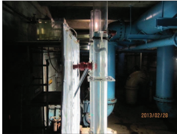
Fuente: Filtro piloto, PTAP
