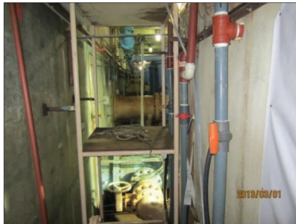
Fuente: Filtro piloto, PTAP
