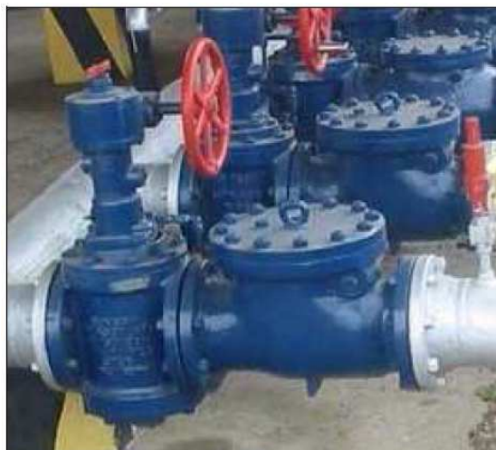
Juego de válvulas Check y Compuerta.
