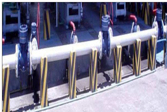
Manifold Secundario de Salida
