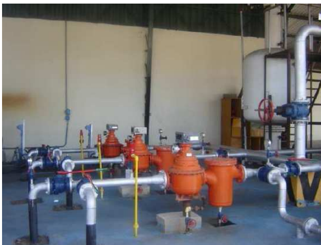
Contadores de Combustible.
