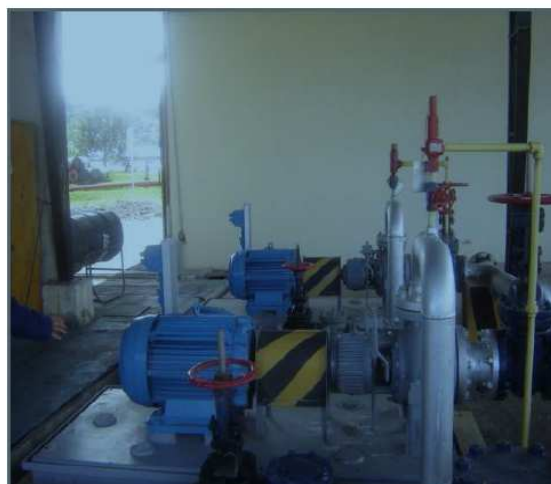
Bomba Booster y Motor Eléctrico.
