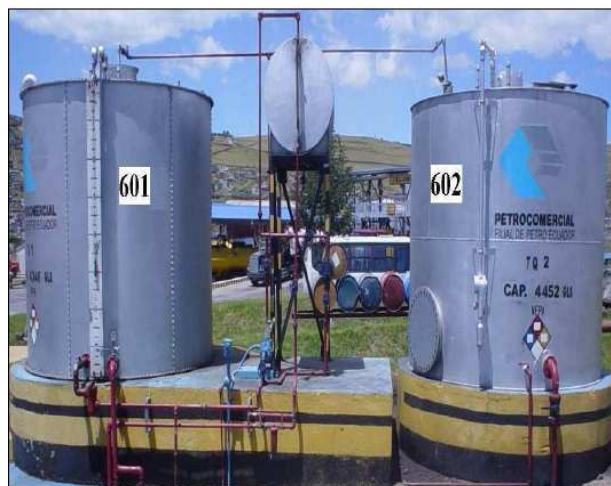
Tanques de Almacenamiento
