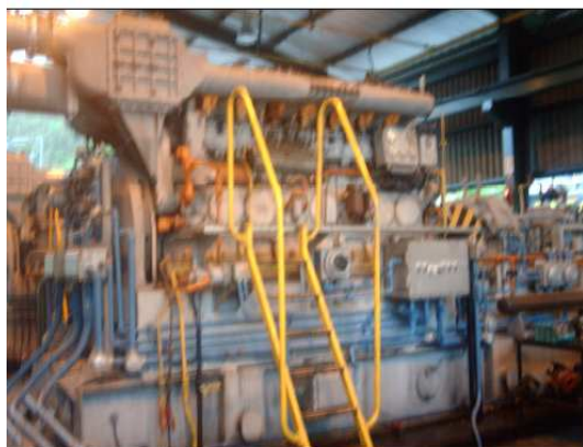
Motor de Combustión Interna
