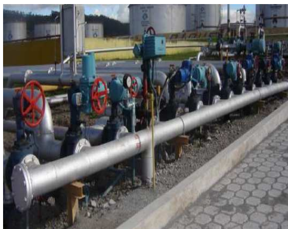
Manifold hacia los tanques de almacenamiento.
