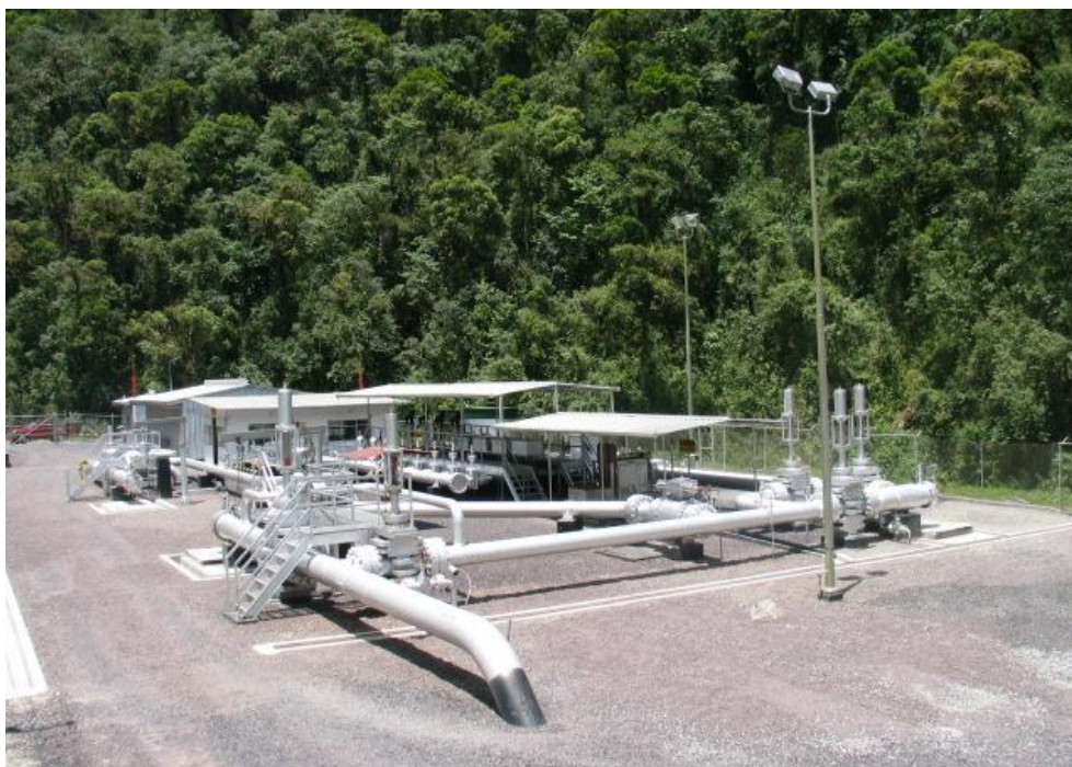
Figura No. 9 Estación de reductora de presión No. 7 Chiriboga
