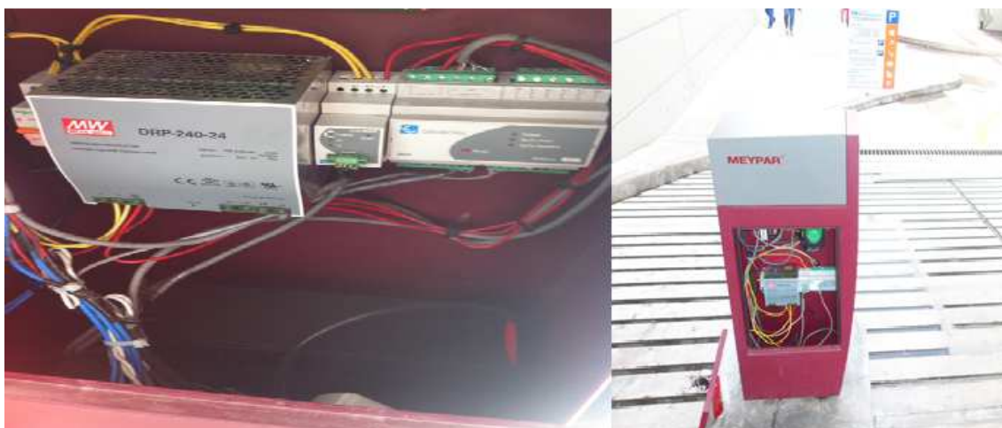
Fig. 3. 31 Equipos de control Implementados y Conectados (Torres Medicas)
