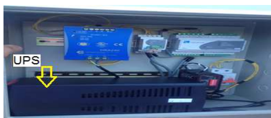
Fig. 3. 5 UPS Instalada en el Gabinete de Control.
