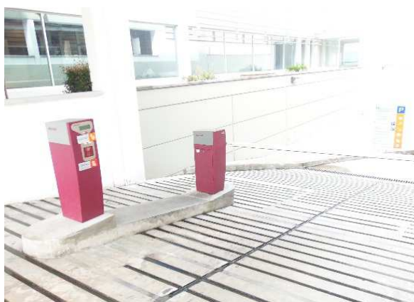
Fig. 2. 46 Equipos Instalados en el Proyecto.
