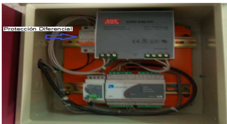
Fig. 3. 4 Protección diferencial instalada en el proyecto
