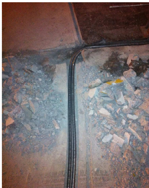
Fig. 2. 23 Tubo Conduit Flexible utilizado en el Proyecto.
