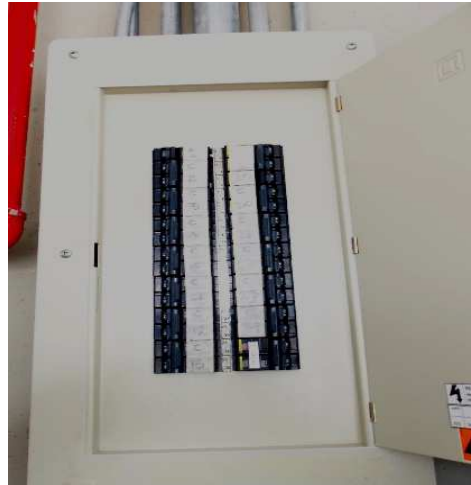
Fig. 2. 16 Tablero de Distribución empleado en el Proyecto.
