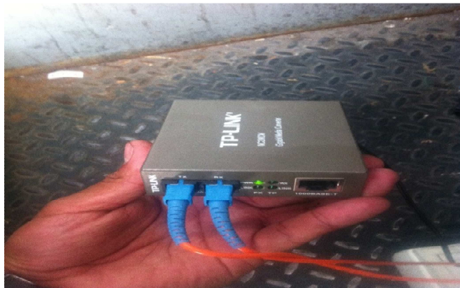
Fig. 3. 20 Convertidor de Fibra Óptica a Ethernet empleado en el proyecto
