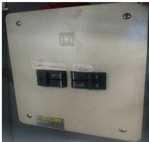
Fig. 3. 9 Protecciones Diferenciales (Breaker) empleados en el proyecto.
