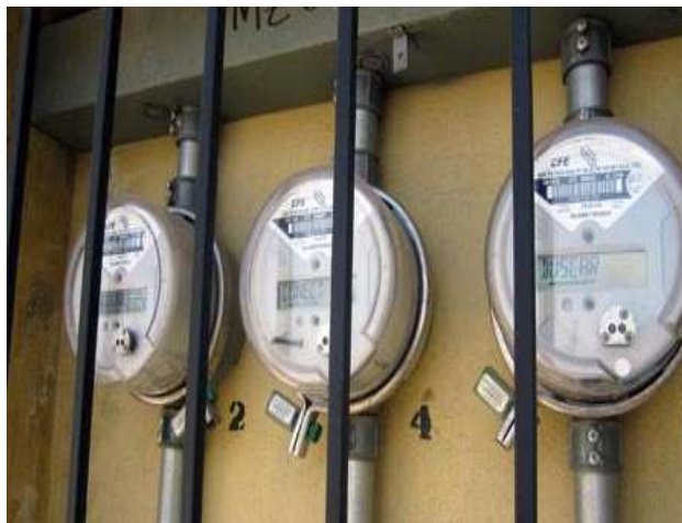
Fig. 2. 9 Medidores de Energía Eléctrica en KW/H.
