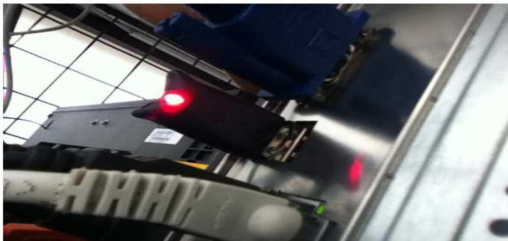
Fig. 4. 8 Licencia Cirpark instalada en el server del Hospital Metropolitano
