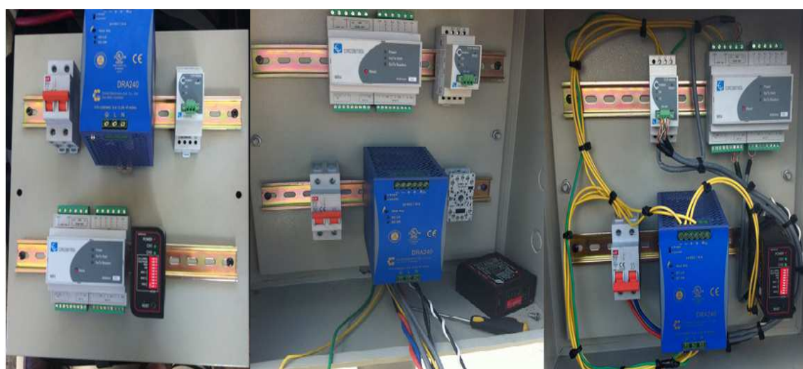
Fig. 3. 33 Gabinete implementado en la extensión del parq. Hosp. Metropolitano.
