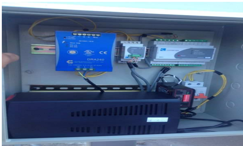
Fig. 3. 2 Equipos de Control instalados en Gabinete
