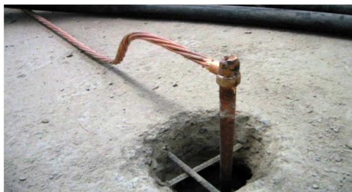
Fig. 3. 11 Varilla Copperweld para sistema de puesta a tierra
