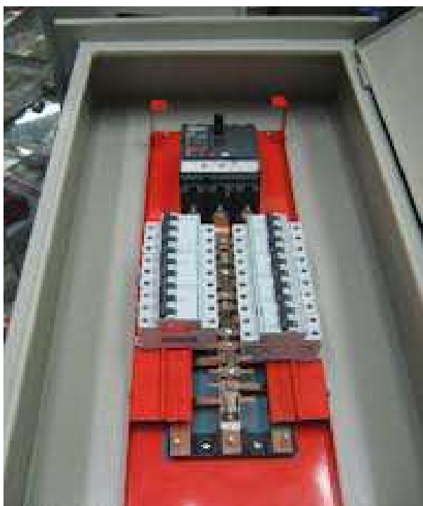
Fig. 2. 15 Tablero Eléctrico General
