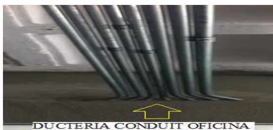
Fig. 3. 6 Ductería Conduit que ingresa a la oficina de control
