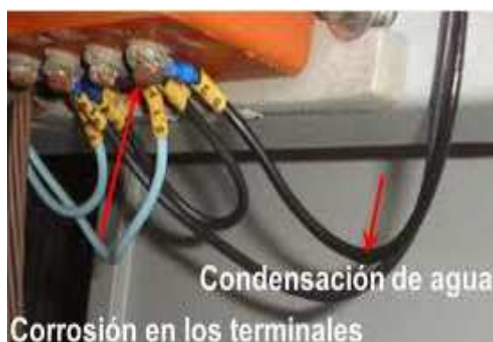
Fig. 2. 2 Instalación Eléctrica en un Lugar Corrosivo.
