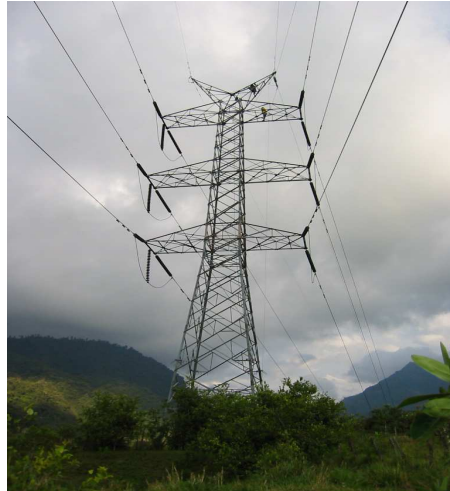
Figura 2.10- Torre de transmisión - Instalaciones de TRANSELECTRIC S.A.
