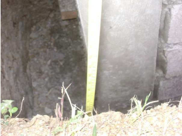
Figura 14. Verificación de profundidades de excavación que se realizaron para corte de terreno.
