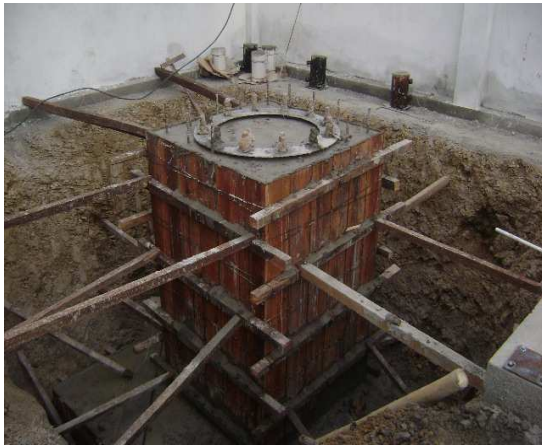
Figura 20. Cimentación con canastilla de pernos para soportar la estructura del monopolo de 18m.
