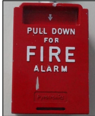
Figura 1.20 Botón de alarma de incendio
