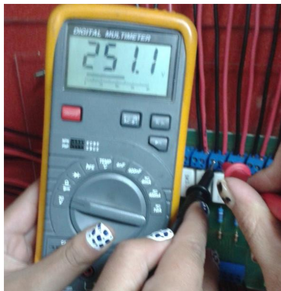
Figura 4.14 Voltaje de la ZONA 7 en estado de ALARMA
