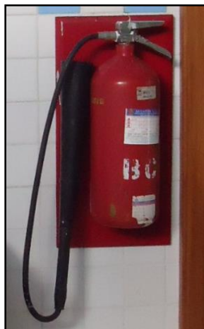
Figura 1.21 Extintor de fuego
