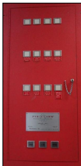
Figura 1.9 Tablero de Control
