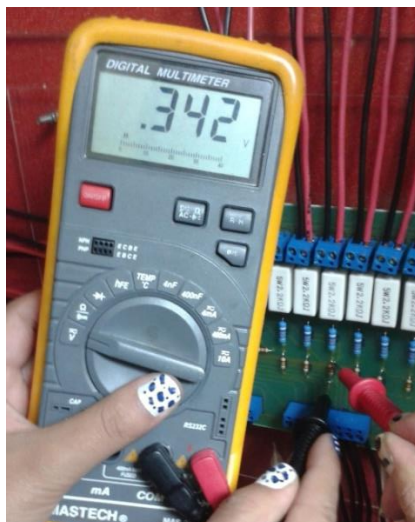
Figura 4.15 Voltaje acondicionado de la ZONA 7 en estado de FALLA
