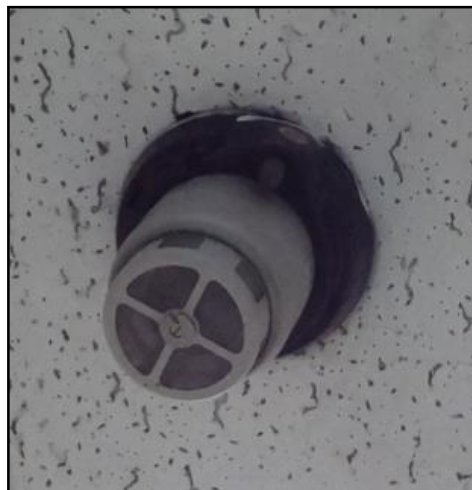
Figura 1.15 Detector de tipo ionizante instalado en el cielo raso
