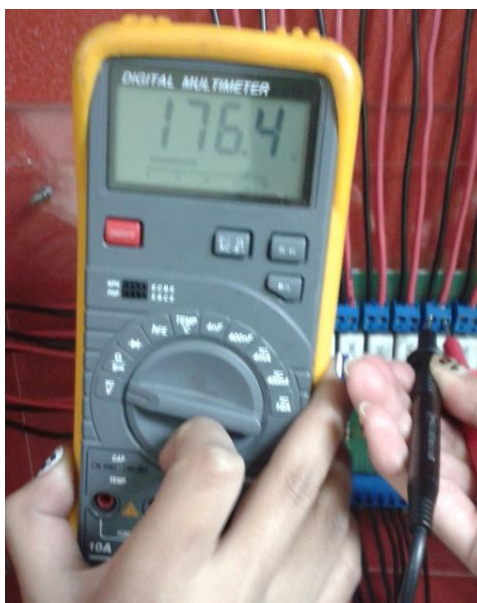
Figura 4.9 Voltaje de la ZONA 8 en estado de ALARMA
