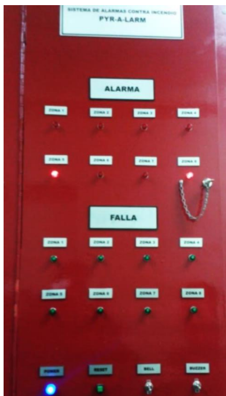
Figura 4.5 Tablero de control en estado de ALARMA
