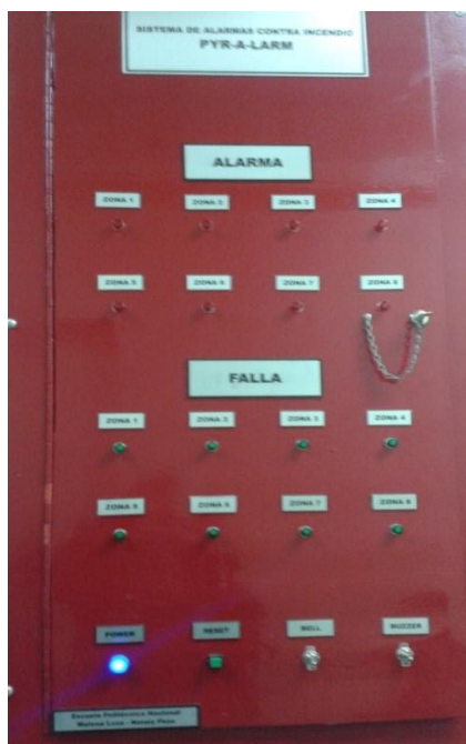
Figura 4.1 Tablero de control en estado NORMAL
