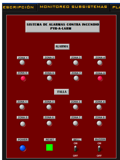
Figura 4.6 Tablero en la interfaz en estado de ALARMA
