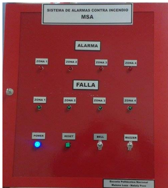
Figura 4.17 Tablero de control en estado NORMAL
