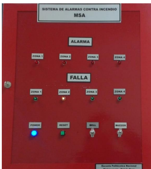
Figura 4.27 Tablero de control en estado de FALLA
