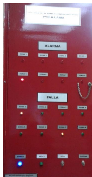
Figura 4.12 Tablero de control en estado de FALLA
