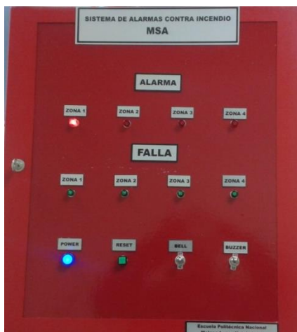
Figura 4.21 Tablero en estado de ALARMA
