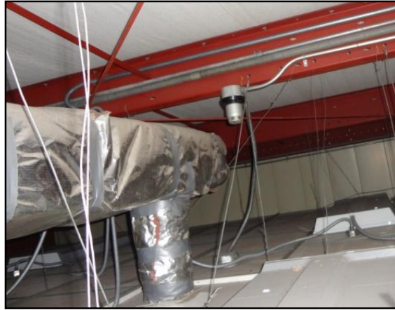
Figura 1.14 Detector de tipo ionizante instalado sobre el cielo raso
