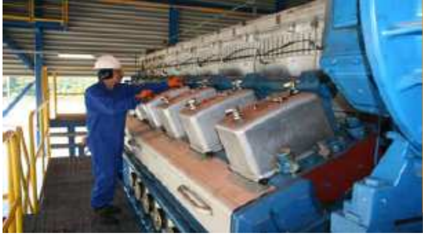
Tareas de mantenimiento en un motor, en una estación de bombeo, propiedad del cliente; ubicada en el oriente ecuatoriano
