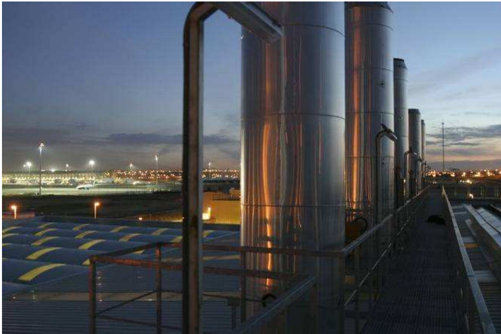
Vista Panorámica desde el interior de una planta de generación de energía eléctrica Fuente: empresa en análisis Elaborado por: empresa en análisis
