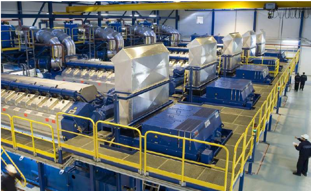
Vista Panorámica interior de una planta de generación de energía eléctrica Fuente: empresa en análisis Elaborado por: Juan Diego Cáceres
