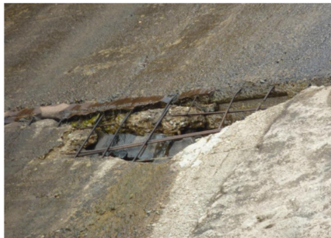
Foto 1.4: Daños por cavitación en el vertedero de la Presa Höljes - Suecia
