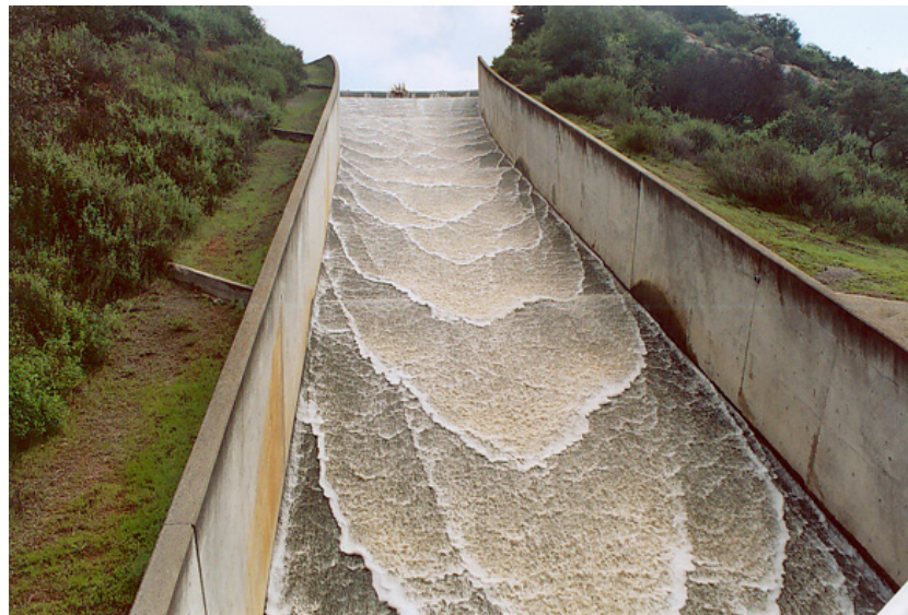
Foto 1.6: Flujo Inestable en vertedero (Presa Turner - California)
