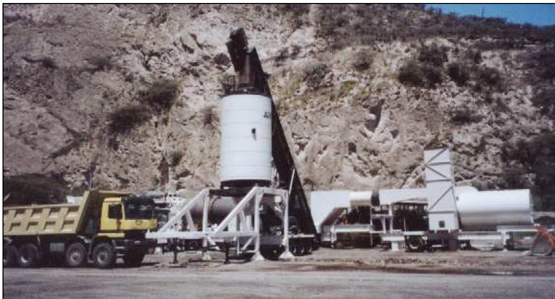
Figura 1.49 Planta De Asfalto Continua
