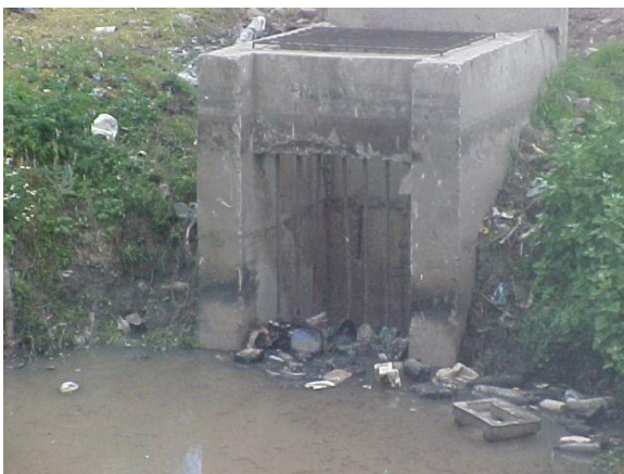
Gráfico 9: Foto de colector localizado en la quebrada Rumipamba en la que se puede observar la acumulación de basuras en la rejilla del último Bloque de la pirámide de tres rejillas.
