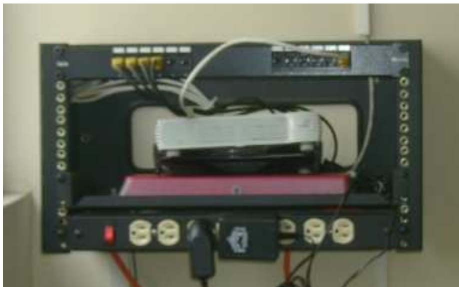
Figura 3.23 Rack de comunicaciones del edificio del CICAM
