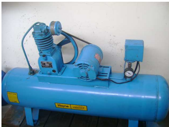
Figura 3.10 Compresor empleado para la aireación el reactor biológico
