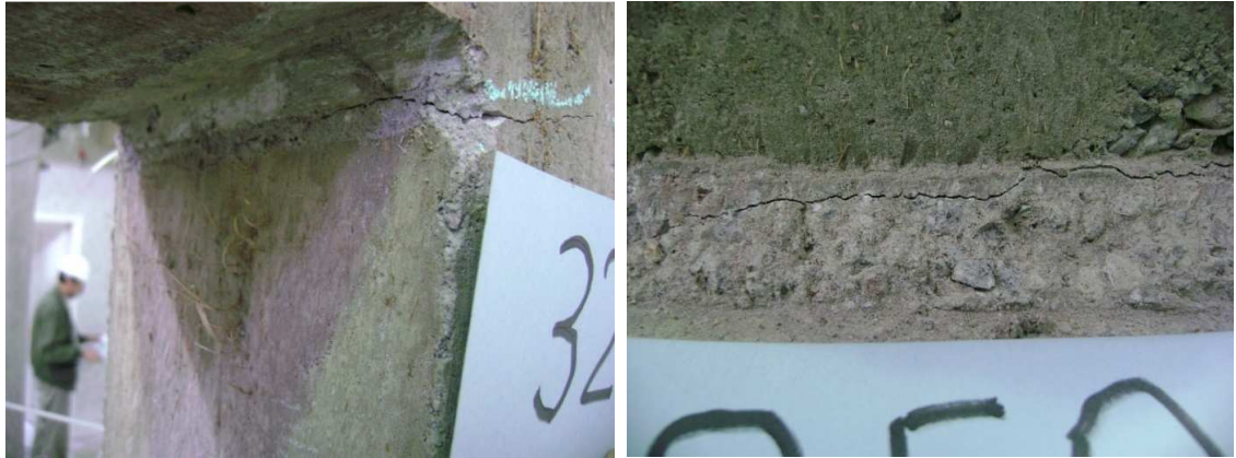
Figura 4.24c. Carga final +3.25Ton.
