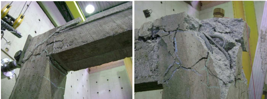
Figura 4.25d. Desplazamiento final -180.0mm
