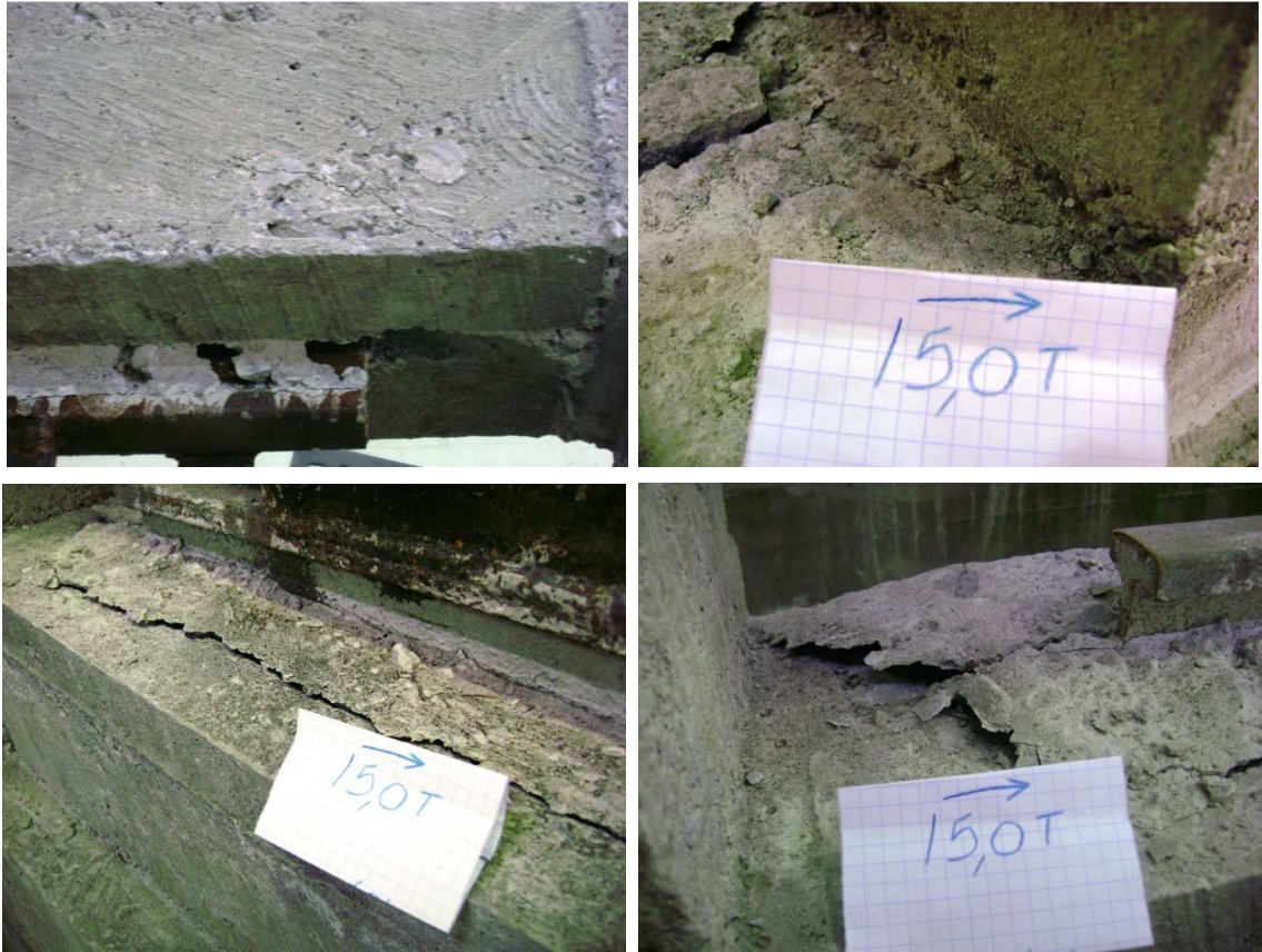
Figura 4.27i. Fisuras y grietas en el pórtico PVEW-vista frontal. Carga 15.0Ton.
