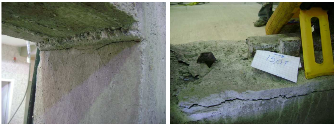
Figura 4.27j. Fisuras y grietas en el pórtico PVEW-vista posterior. Carga 15.0Ton.
