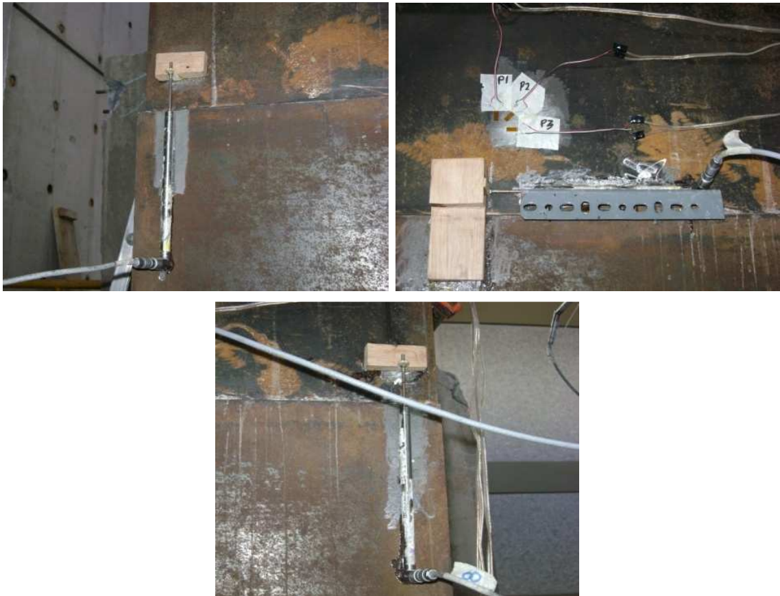
Figura 4.19. LVDTs izquierdo, central y derecho colocados en el muro viscoelástico.
