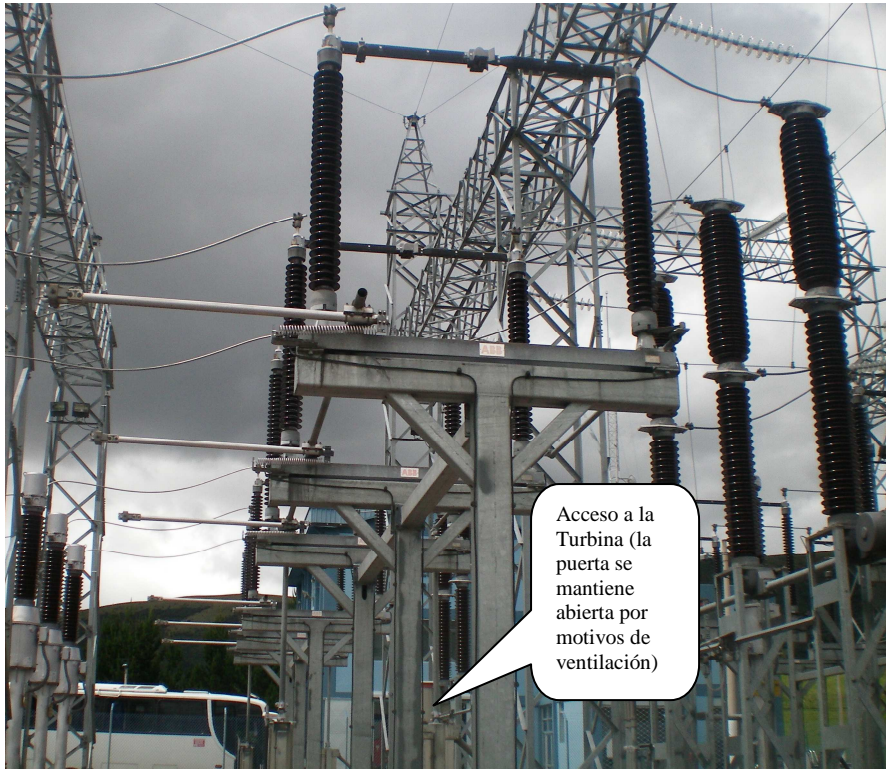
Fotografía Nº 3.3. Central Hidroeléctrica El Carmen, área de Transformadores.
