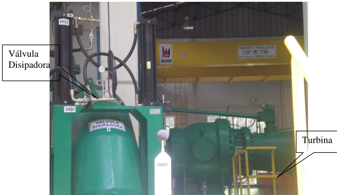
Fotografía N° 3.4. Válvula disipadora de energía, Central Reguladora Sistema Papallacta.
