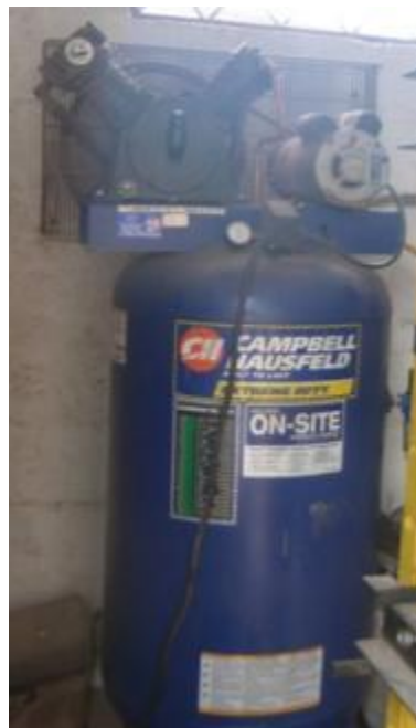
Figura 3.8: Limpieza del compresor principal
