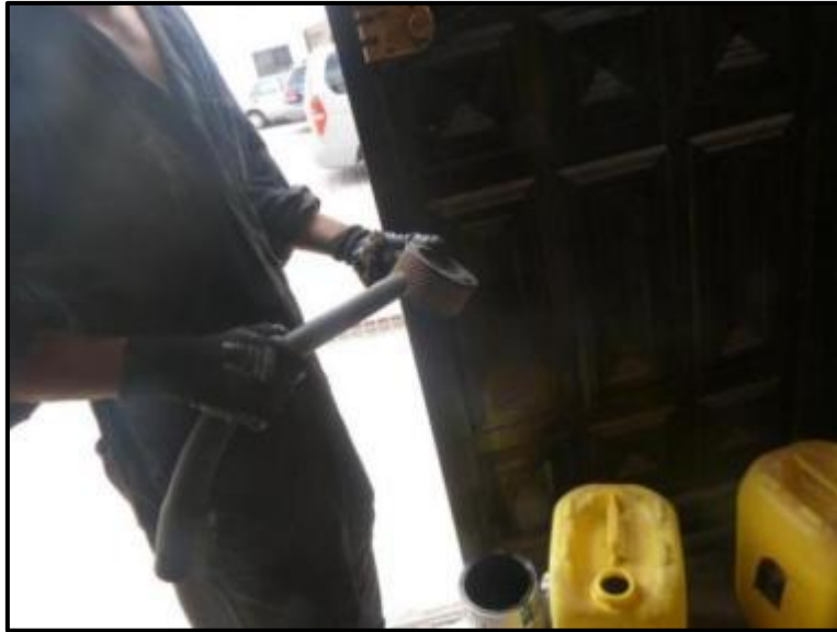
Figura 3.9: Limpieza el Filtro de aire del compresor 1 34
