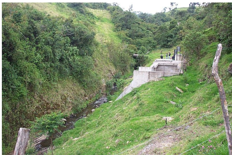
Fotografía No. 6.6: Cámara de válvulas - margen lateral izquierda (río Santa Clara)
